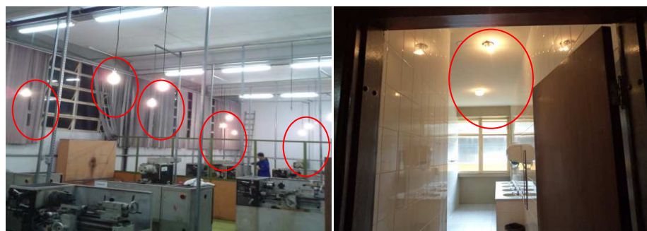
Fotografia 3.2: Iluminação com Lâmpadas Incandescentes.
