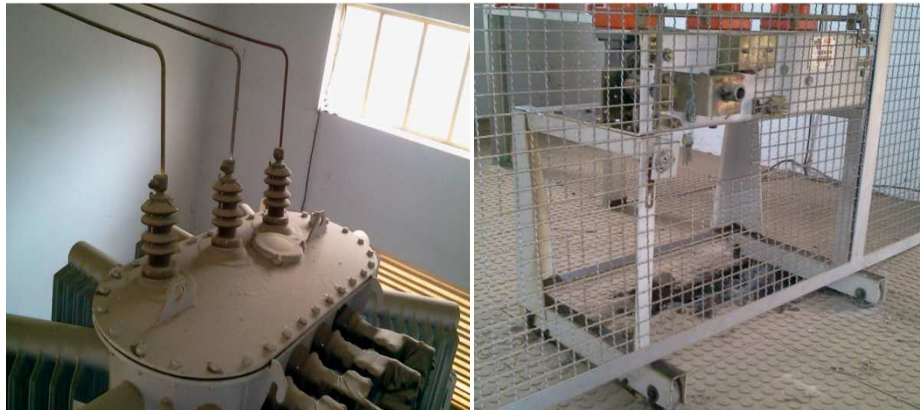
Fotografia 3.5: Cabine de Entrada de Energia. Fonte: Autor.
