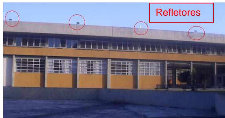
Fotografia 3.4: Iluminação Externa. Fonte : Autor.
