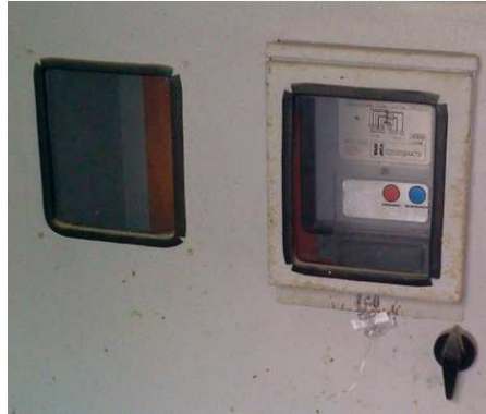
Fotografia 3.6: Foto do Medidor de Energia. Fonte: Autor.
