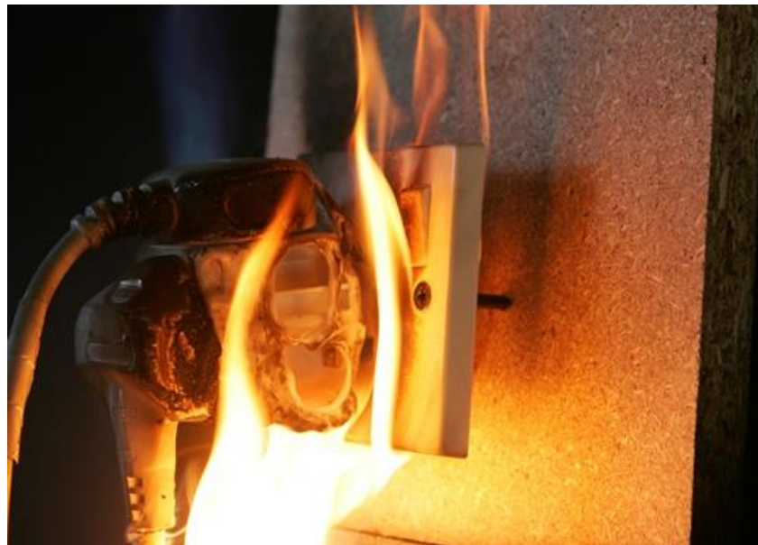
FIGURA 11 – SOBRECARGA NA TOMADA FONTE: (FREITAS, 2016)
