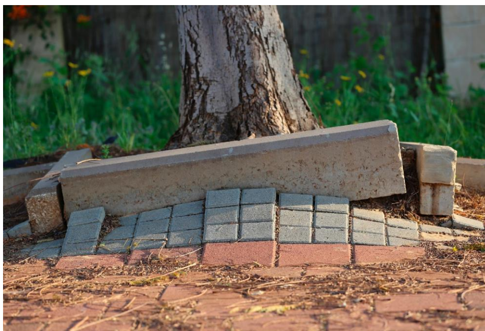
Figura 3: Danificação da calçada devido a problemas com as raízes da árvore. Fonte: Getty Images, 2012.
