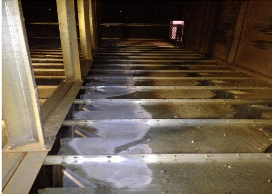
Figura 7 – Estrutura após incêndio Fonte: Autor
