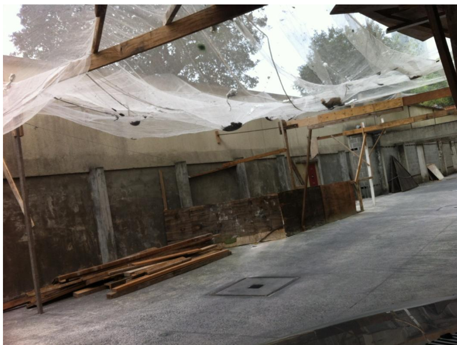
Figura 34. Tela de proteção para queda de materiais e equipamentos. Fonte: O autor (2014).
