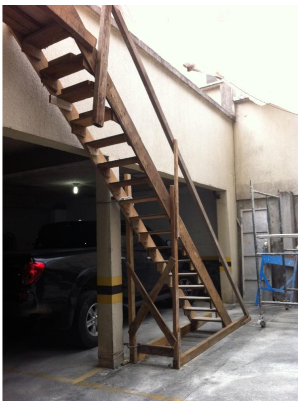
Figura 31. Escada de madeira para acesso à bandeja de proteção. Fonte: O autor (2014).
