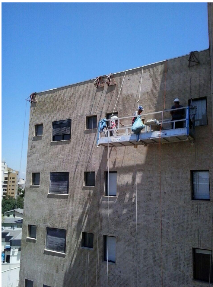
Figura 32. Equipamentos de proteção coletiva no andaime suspenso. Fonte: O autor (2014).
