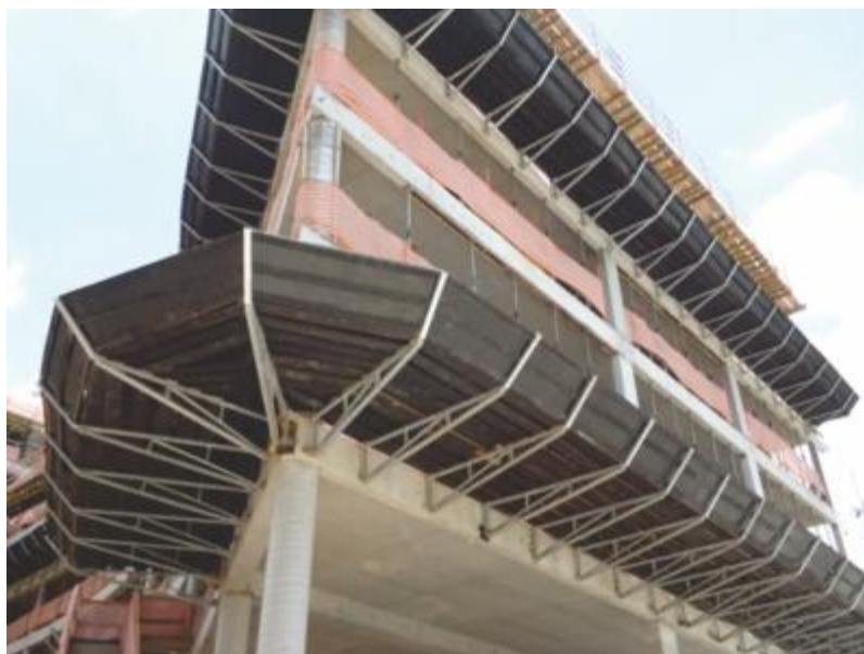
Figura 13. Plataforma principal de proteção. Fonte: SINTRACON, 2014.
