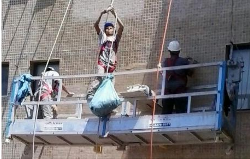
Figura 39. Equipamentos de segurança utilizados no trabalho sob balancins. Fonte: O autor (2014).
