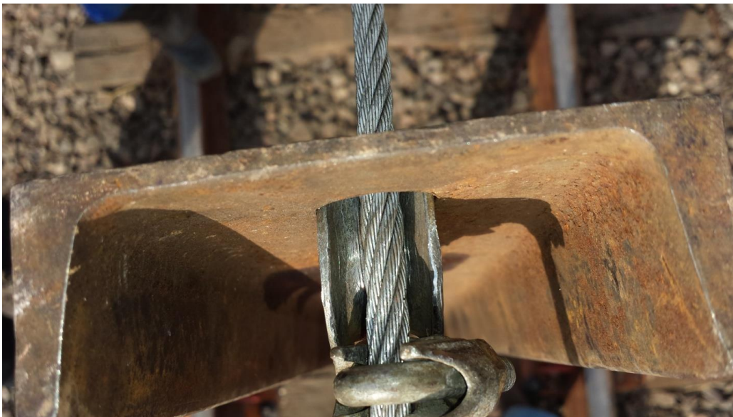
Figura 5 – Perfil U para fixação de cabo de aço 8mm. Fonte: O autor (2014)
