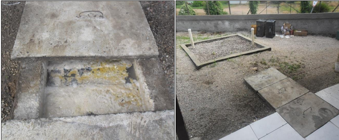
Figura 26 A. Caixa de gordura restaurante. B caixa de gordura, e ETEZR. Fonte: Autora.
