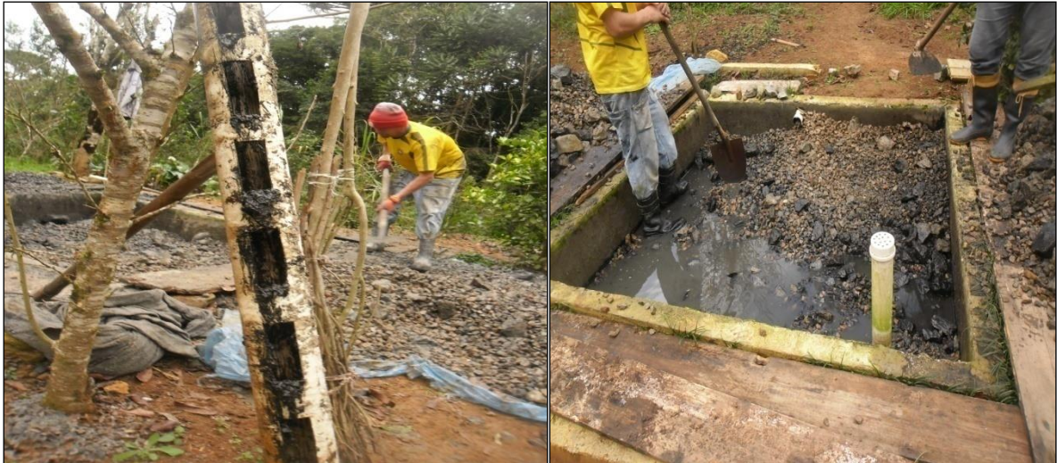
Figura 18 A. Tubulações de distribuição. Fonte: Autora.
