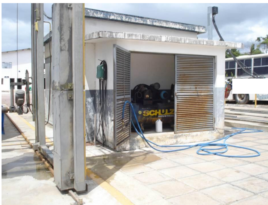
Figura 12 - Compressor de ar Fonte: Autora, 2012.
