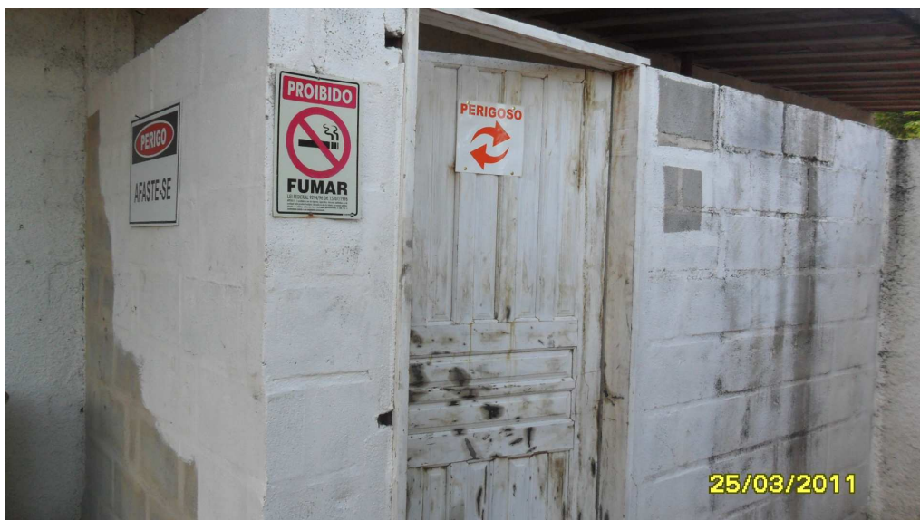
Figura 3 - Detalhe do local de armazenamento dos resíduos Classe I –perigosos, na obra de Fundão, ES.
