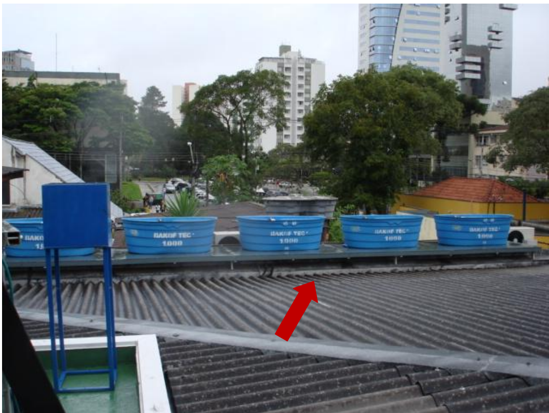
Figura 3 – Local de instalação dos biorreatores.
