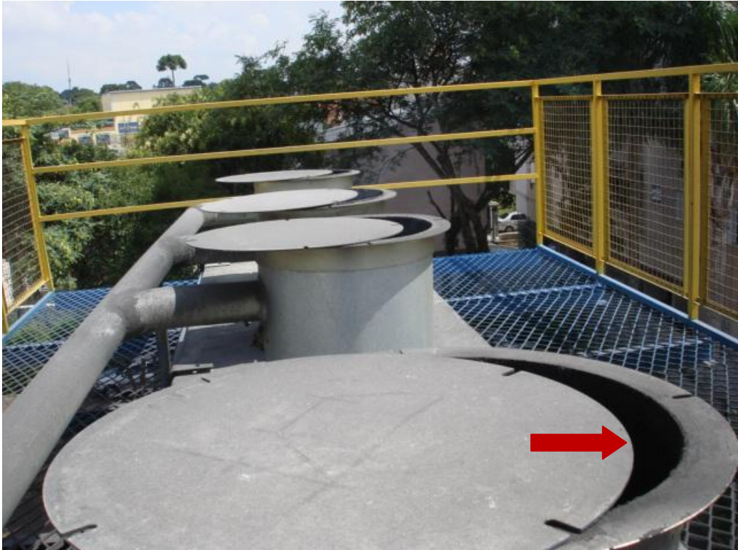
Figura 9 – Regulagem da abertura dos dutos para vazão de saída da fumaça.
