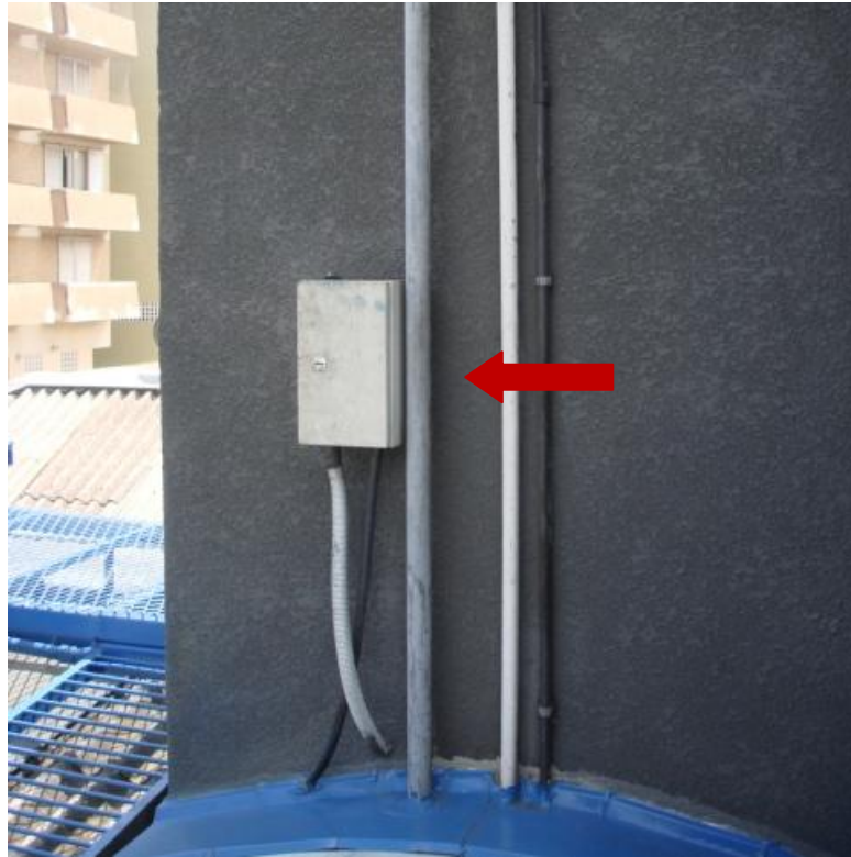
Figura 12 – Sistema elétrico sem sinalização.
