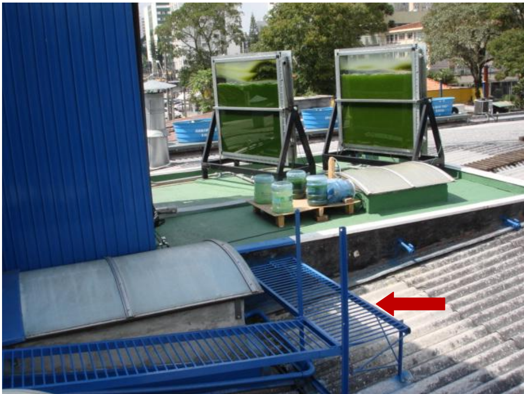
Figura 6 – Rampa de acesso aos fotobiorreatores desprovida de corrimão.
