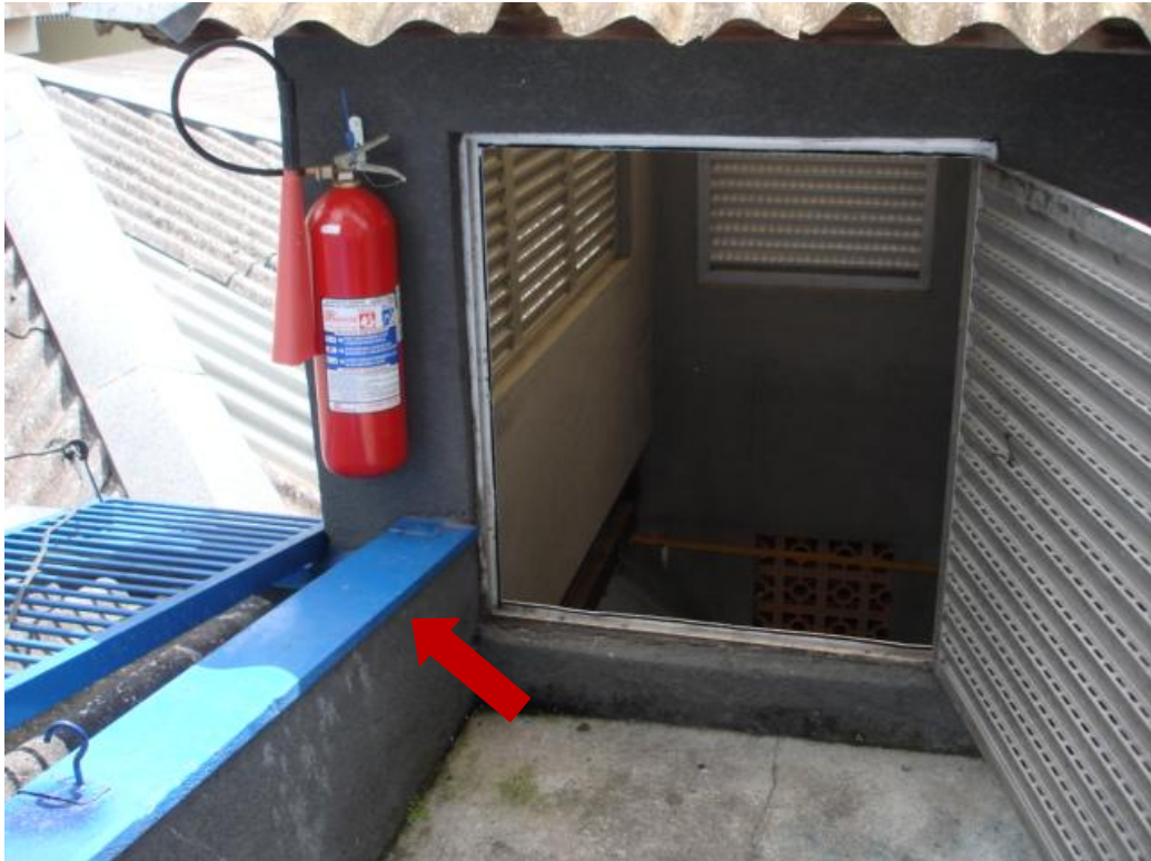
Figura 11 – Extintor desprovido de qualquer tipo de sinalização.
