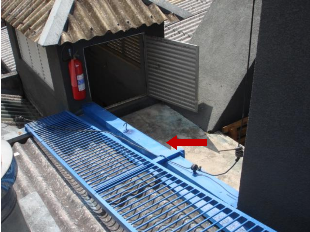
Figura 5 – Acesso à rampa, que deveria ser feito por meio de degrau.
