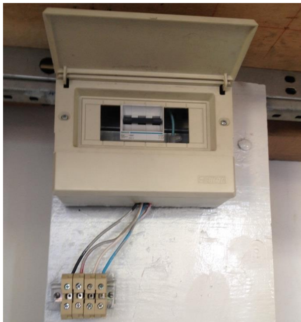
Figura 18 – Quadro de Distribuição da Bancada de Eletricidade Predial sem aterramento e sem DR Fonte: (O autor, 2015)
