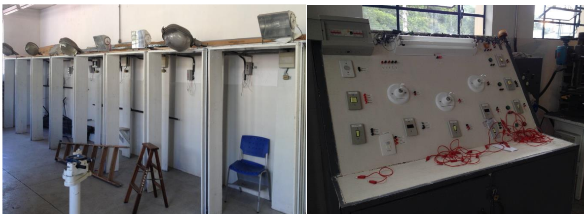
Figura 13 – Bancadas de Eletricidade Predial Fonte: (O autor, 2015)
