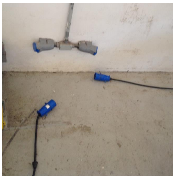
Figura 17 – Tomadas de Alimentação das Bancadas Fonte: (O autor, 2015)
