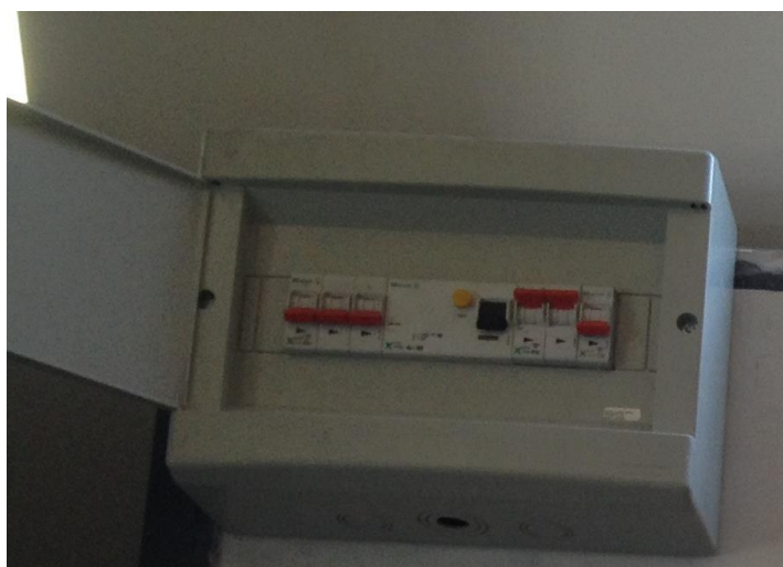
Figura 20 – Quadros de Distribuição (QD) com DR de baixa sensibilidade Fonte: (O autor, 2015)
