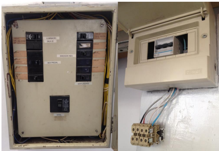
Figura 16 – Quadros de Distribuição (QD) Fonte: (O autor, 2015)
