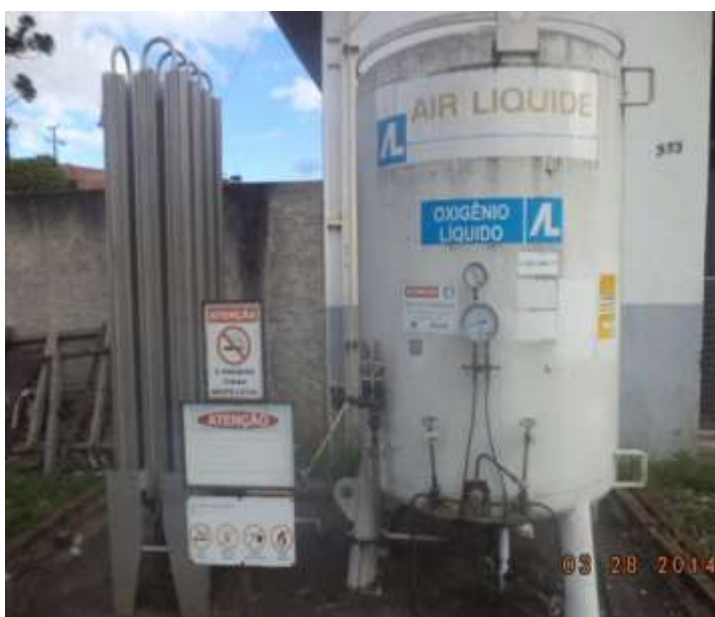
Figura 18 - Vista geral do tanque criogênico (VP) usado para armazenagem de Oxigênio
