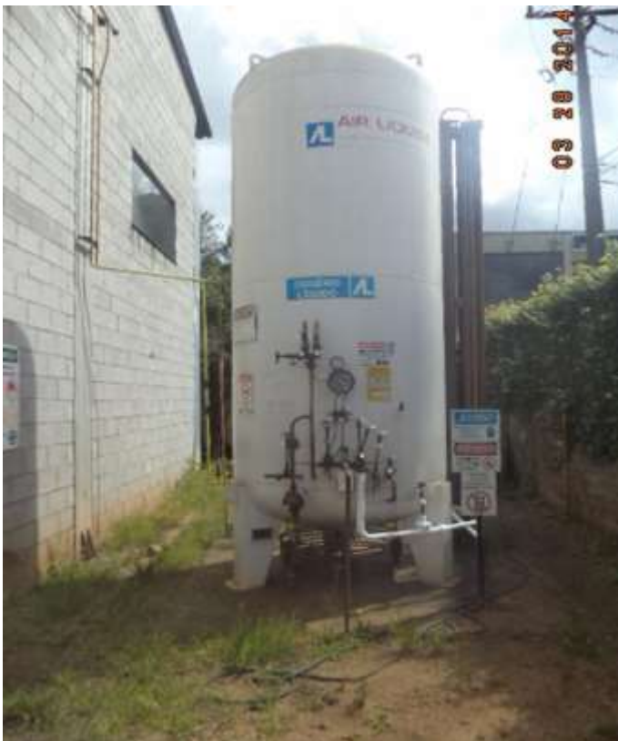
Figura 13 - Vista geral do tanque criogênico (VP) usado para armazenagem de Oxigênio
