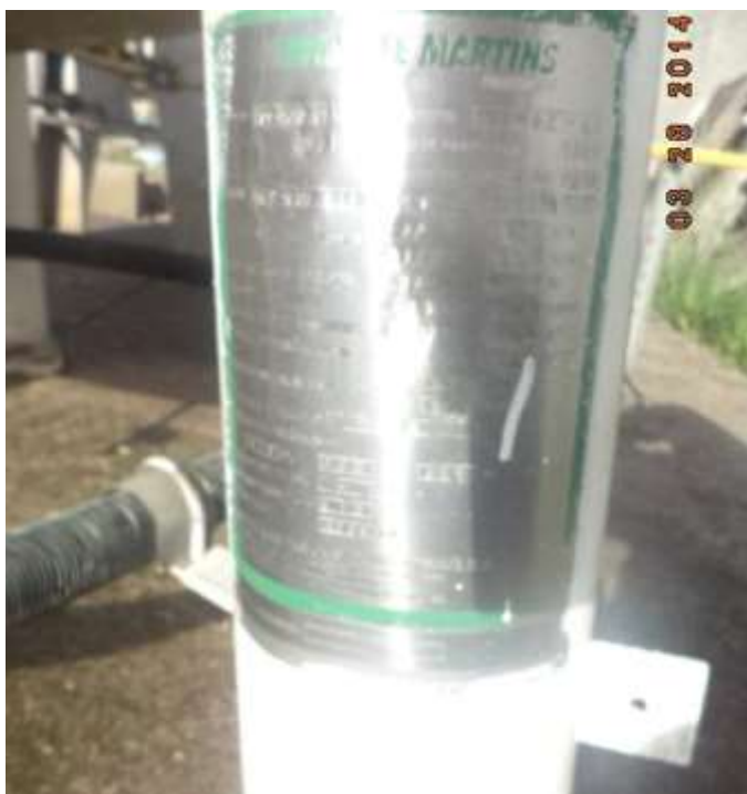
Figura 21- Placa de identificação Fonte: Autor (2014).
