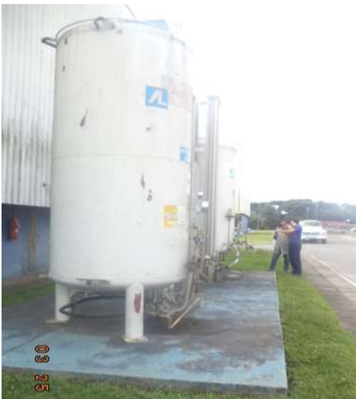
Figura 30 – Localização do vaso de pressão Fonte: Autor (2014).
