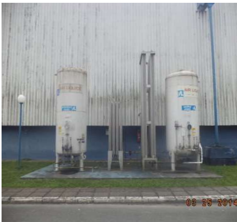
Figura 25 - Vista geral do tanque criogênico (VP) usado para armazenagem de Oxigênio
