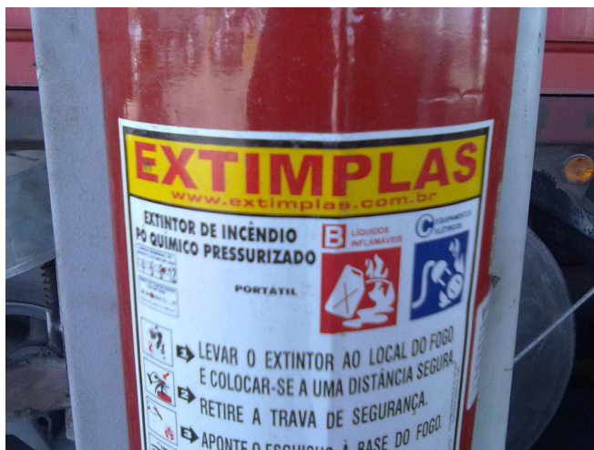
Figura 19 – Detalhe do extintor de incêndio do empreendimento. Fonte: Autor (2014).
