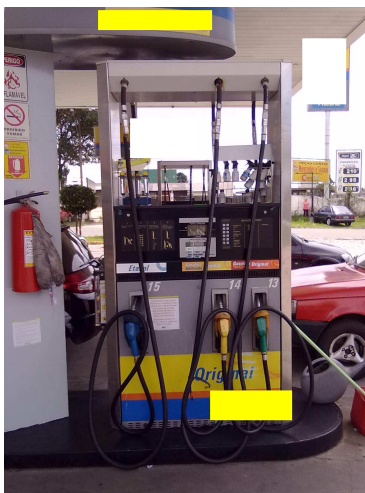
Figura 5 – Bomba de abastecimento da área 02.
