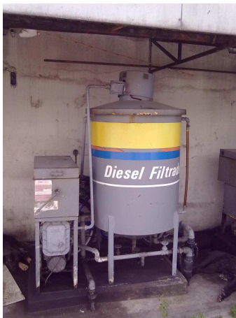
Figura 11 – Vista geral do filtro de diesel do empreendimento. Fonte: Autor (2014).
