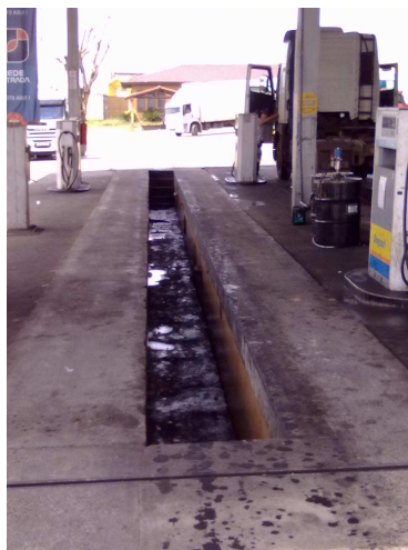
Figura 6 – Vala de troca de óleo na área de abastecimento 01. Fonte: Autor (2014).
