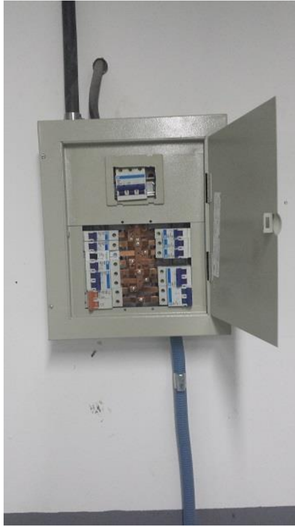
Figura 12 – Vista do quadro elétrico do empreendimento C Fonte: O autor (2015).
