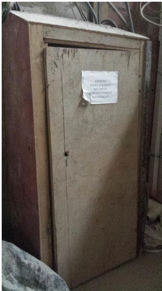
Figura 13 – Vista do quadro elétrico do empreendimento C Fonte: O autor (2015).
