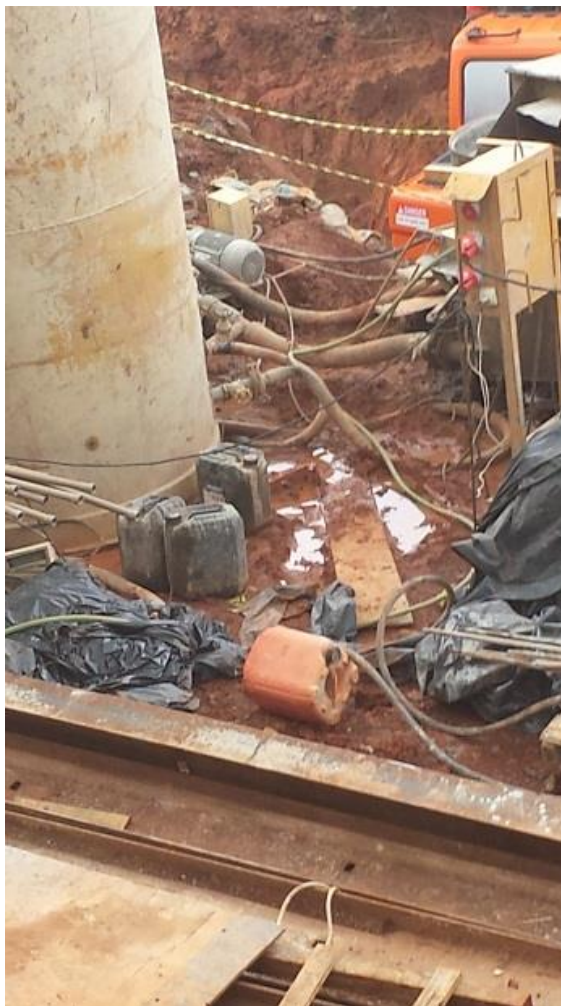
Figura 5 – Vista de combustíveis armazenados do empreendimento A Fonte: O autor (2015).
