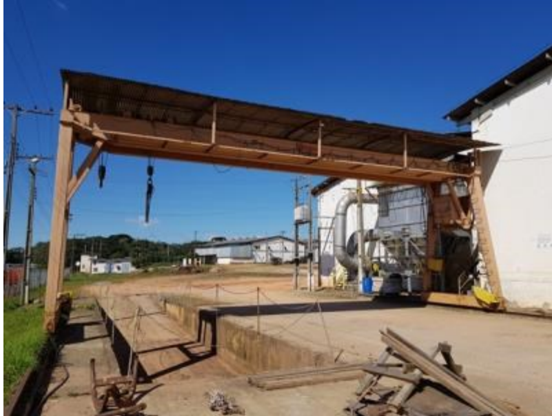
Figura 2 – Pórtico de descarga de toras
