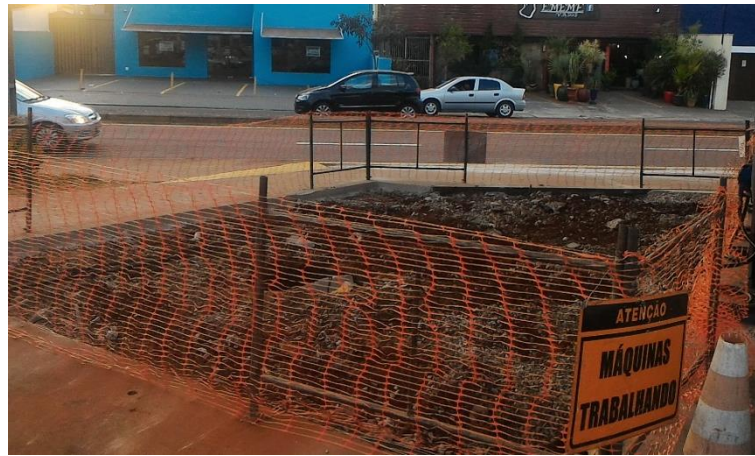
Figura 13 – Isolamento adequado da área. Fonte: a autora, 2016.
