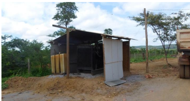
Figura 12 - Gerador localizado dentro da usina de asfalto do lote 2 Fonte: ITTI/UFPR (2016)
