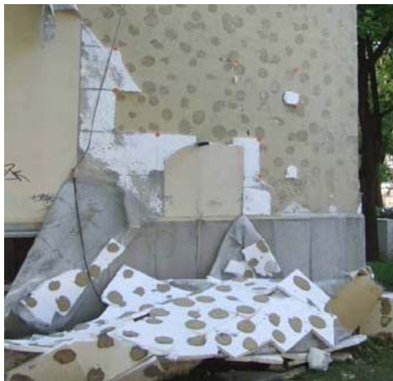
Figura 18 - Queda quase integral do sistema ETICS, devido à insuficiência de cola aplicada entre as placas de isolamento e a parede de base. (FLOREA, 2012)
