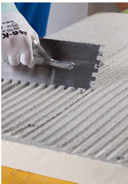
Figura 21 – Ilustração do método de aplicação da argamassa colante em uma placa de EPS. (MAPEI, 2014)
