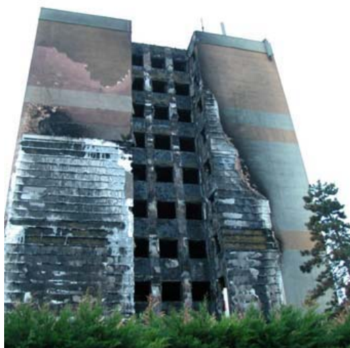
Figura 19 – Incêndio fatal num edifício em 2010, em Dijon (França). Fachada ETICS com isolante EPS (FLOREA, 2012).
