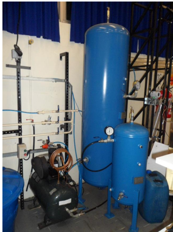
Figura 28: Compressor de ar
