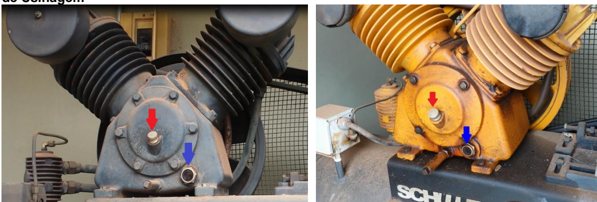
Figura 5: Indicado pelas setas vermelhas tem-se os pontos de lubrificação do eixo e indicado pelas setas azuis tem-se o visor de lubrificação nos compressores utilizados pelo laboratório de Usinagem
