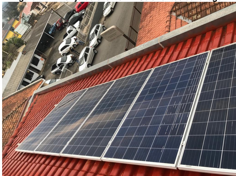
Figura 24: Arranjo do cliente BK Solar antes da lavagem.
