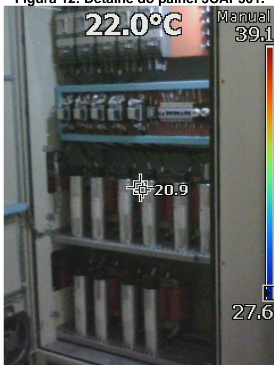
Figura 12: Detalhe do painel 3CAP501.
