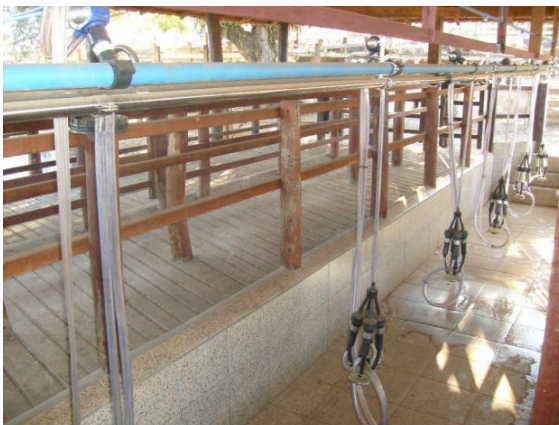
Figura 6: Canalização Fonte: Agricol (2009)
