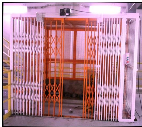
Figura 1: Elevador de cargas atual. Fonte: Autoria própria.
