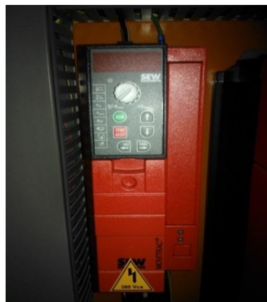
Figura 19: Inversor SEW instalado no painel de controle. Fonte: autoria própria.
