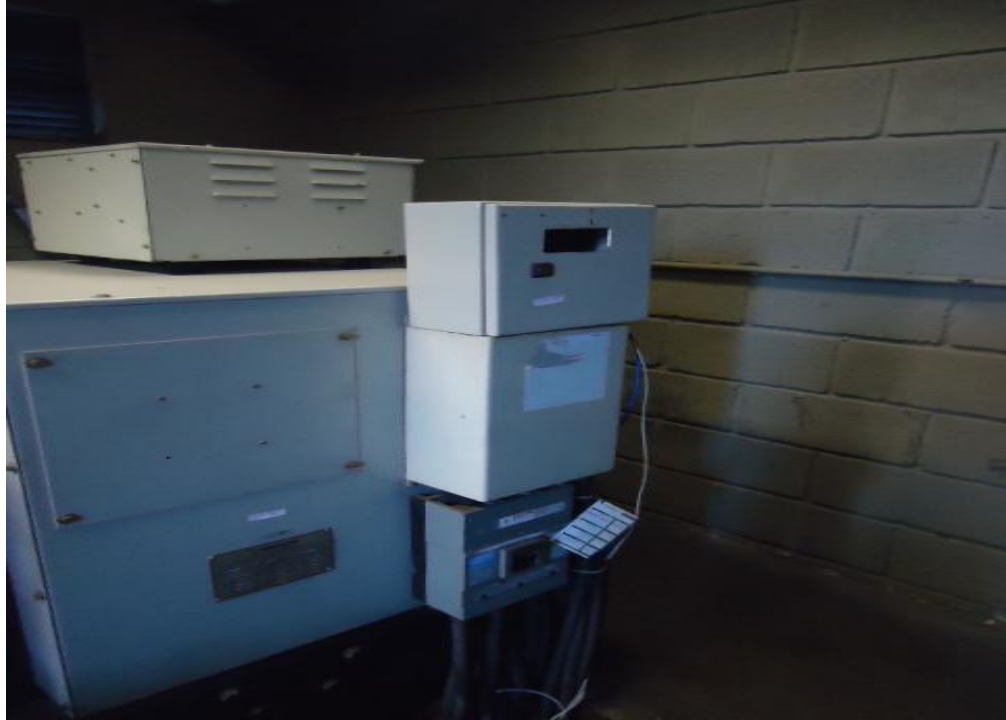
Figura 18: Instalação da placa de aquisição de dados
