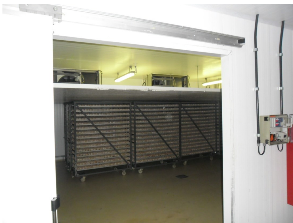
Figura 2 – Sala de pré-aquecimento.
