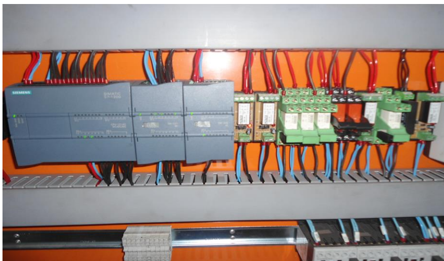
Figura 9: Componentes acondicionados no painel elétrico
