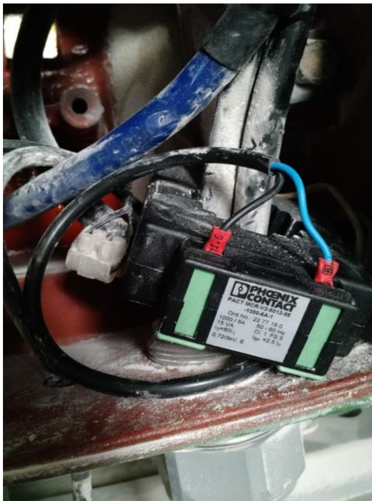
Figura 11. TC instalado no motor do exaustor local. Fonte: Aatoria Própria.
