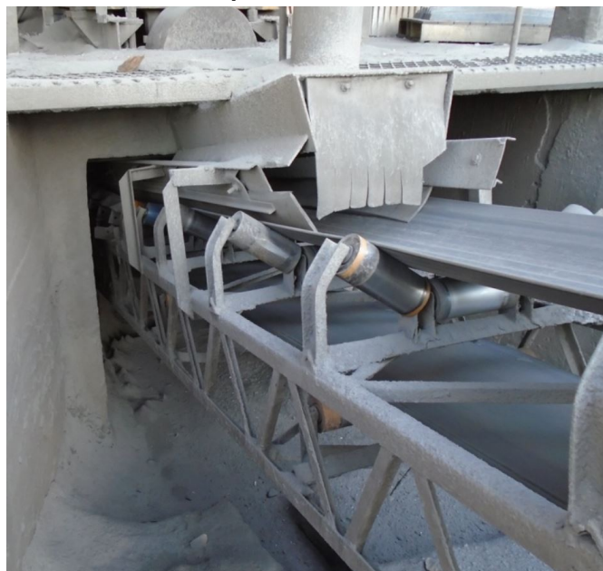
Fotografia 3 – Problemas do Captor C na correia transportadora
