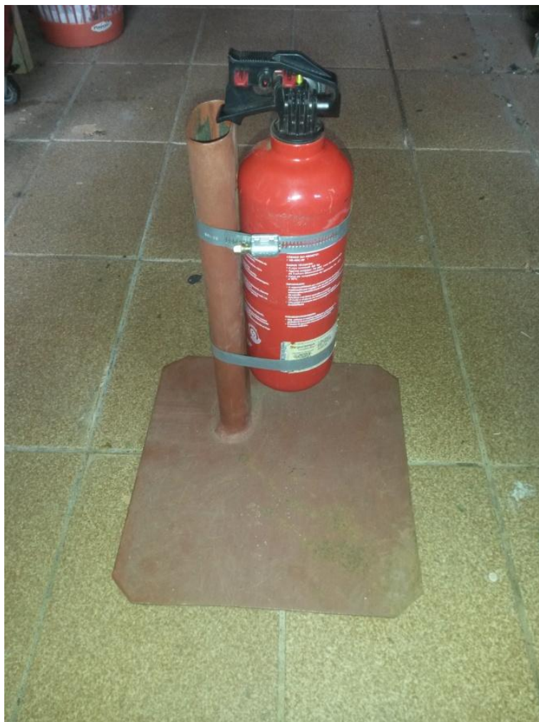
Fotografia 17: Chapas de base com um extintor fixado na coluna por meio de um par de abraçadeiras.
