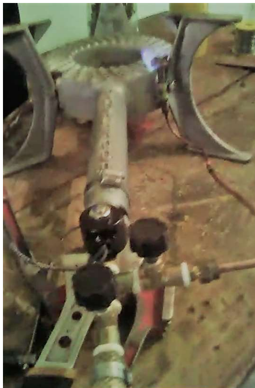
Figura 28 - Sistema de aquecimento com chama piloto
