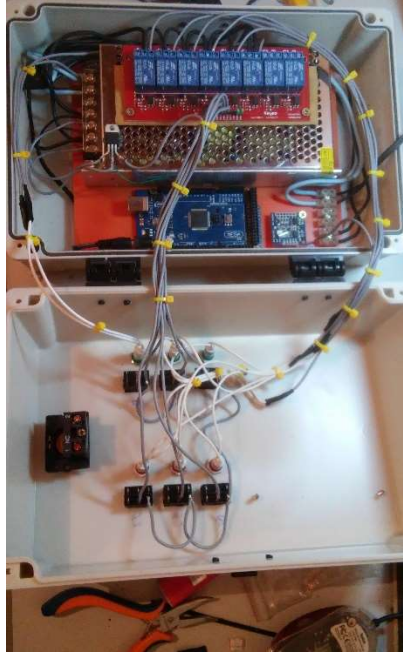
Figura 37 - Cabeamento do painel
