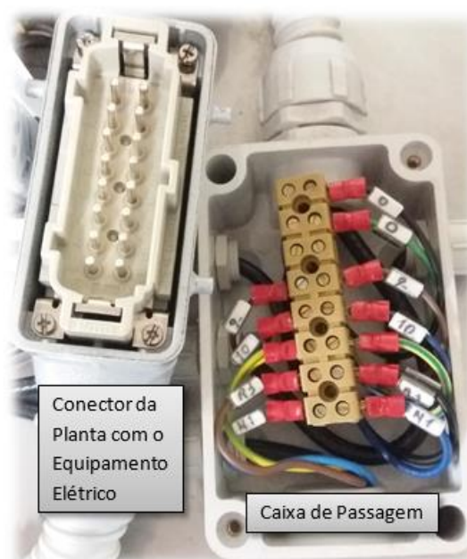
Figura 7 – Conector da Planta com Equipamento Elétrico e caixa de passagem
