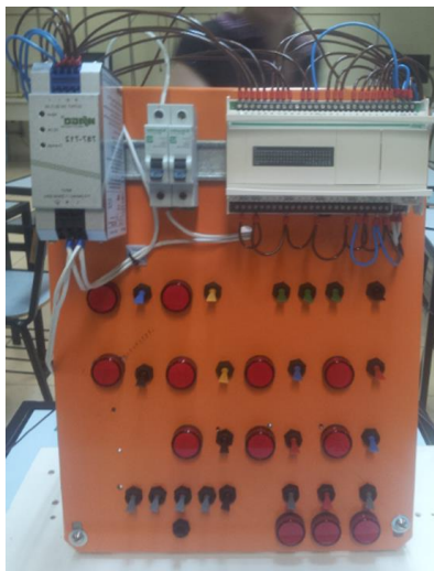
Figura 34 - Quadro de comando Fonte: Autoria própria.
