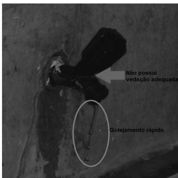
Figura 14: Torneira da lavanderia com vedação inadequada.
