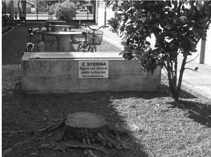
Figura 29: Cisterna semi-enterrada para armazenamento da água da chuva
