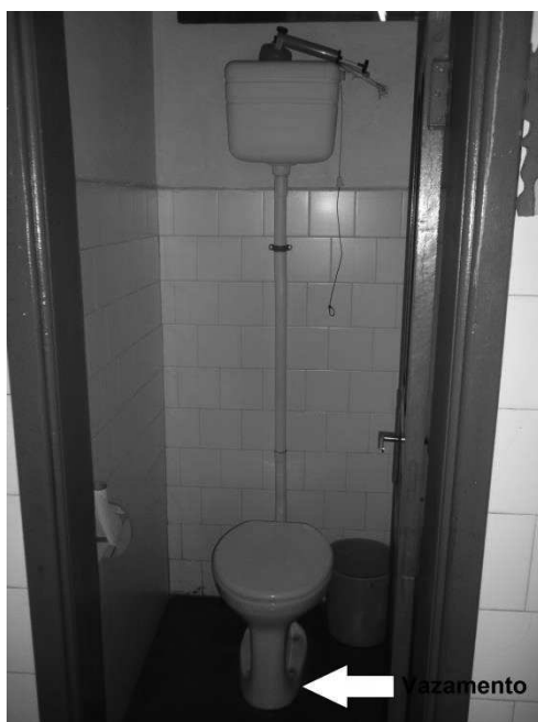
Figura 13: Bacia sanitária, que contém vazamento, com caixa elevada.
