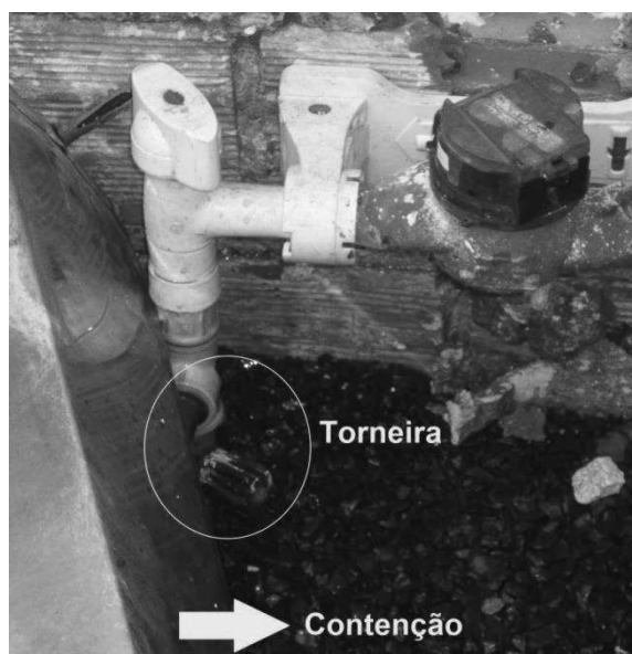
Figura 19: Contenção sobre a torneira durante utilização da mangueira.
