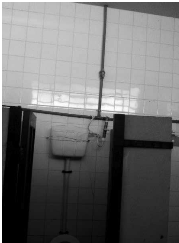
Figura 32: Instalação do sistema de aproveitamento da água da chuva no banheiro dos alunos.
