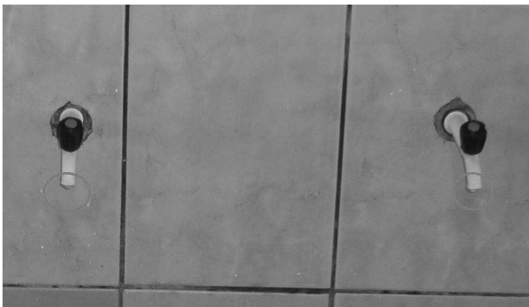
Figura 15: Torneiras dos lavatórios externos com vedação inadequada.
