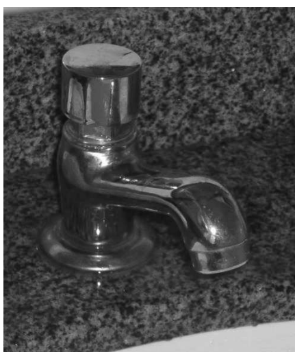
Figura 23: Exemplo de torneira hidromecânica existente nas escolas públicas.
