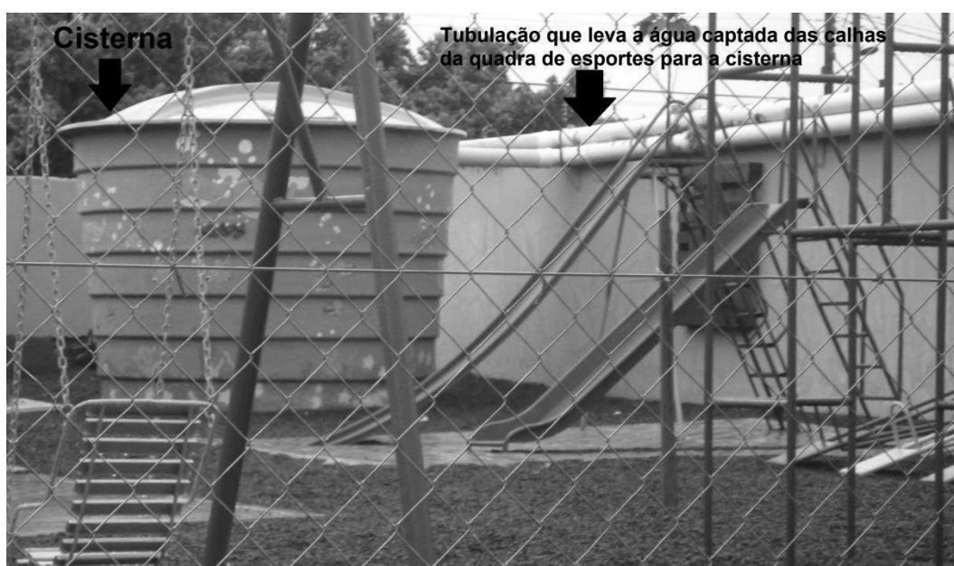
Figura 27: Tubulação que leva a água pra cisterna na Escola ‘G’.
