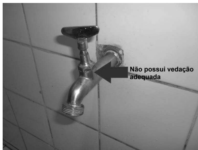
Figura 12: Torneira sem adequada vedação.
