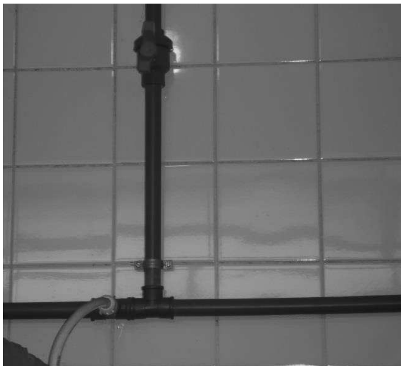
Figura 31: Válvula solenóide no banheiro feminino.
