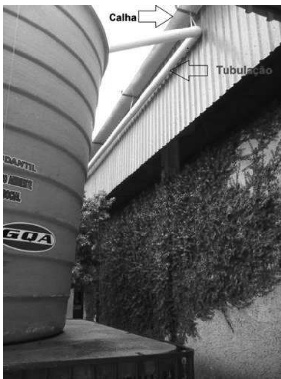
Figura 28: Captação da água para a cisterna no Colégio 2.
