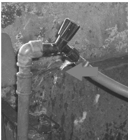
Figura 17: Vazamento de água na hora da limpeza.
