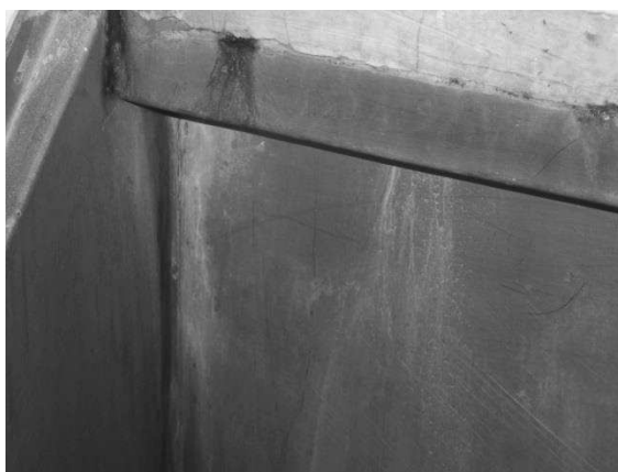
Figura 16: Mictório com patologias.
