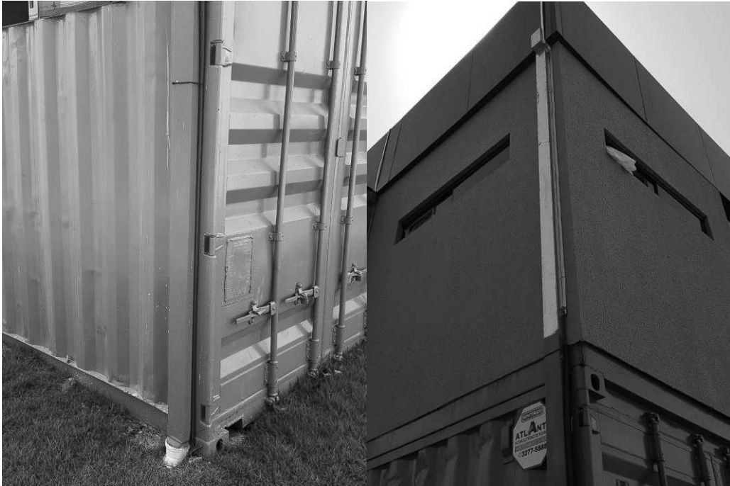
Figura 34 – Sistema de escoamento das águas pluviais Fonte: Autoria Própria, 2017.
