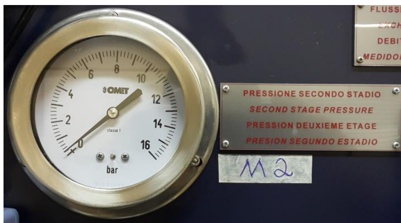
Figura 19 - Manômetro de Bourdon (M 2 ), usado para medir a pressão de distribuição atingida na 2ª fase de compressão.
