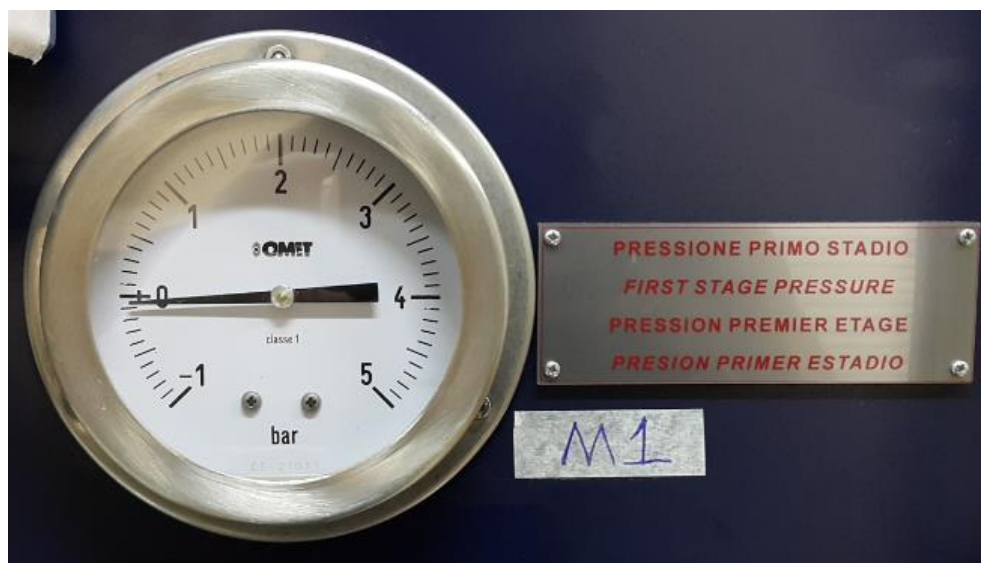
Figura 16 - Manômetro de Bourdon (M 1 ), usado para medir a pressão de distribuição atingida na 1ª fase de compressão.
