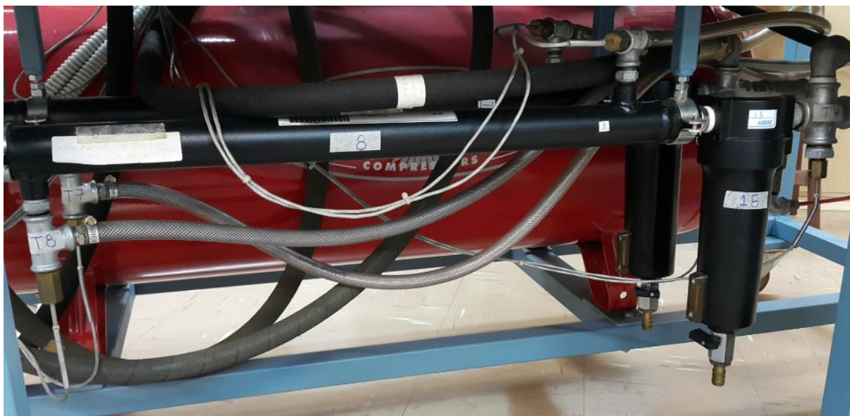
Figura 18 - Parte inferior da bancada com o sistema de resfriamento, trocador de calor do tipo casco e tubo final indicado pela etiqueta número 8, e dos filtros de ar indicados pela etiqueta de número 15 com suas respectivas válvulas de descarga de condensado.
