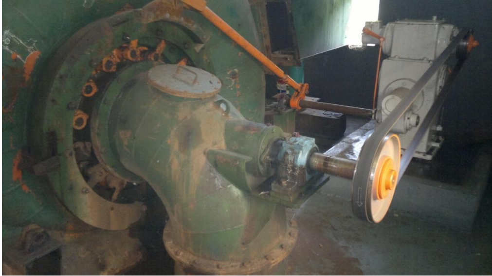
Figura 11 – Turbina Hidráulica CGH Salto São Luiz Fonte: Autoria Própria.
