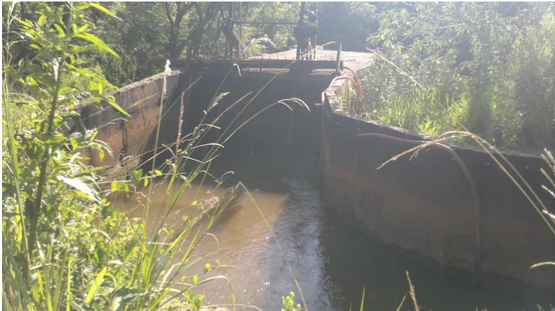
Figura 14 – Grade de Limpeza CGH Fonte: Autoria Própria.
