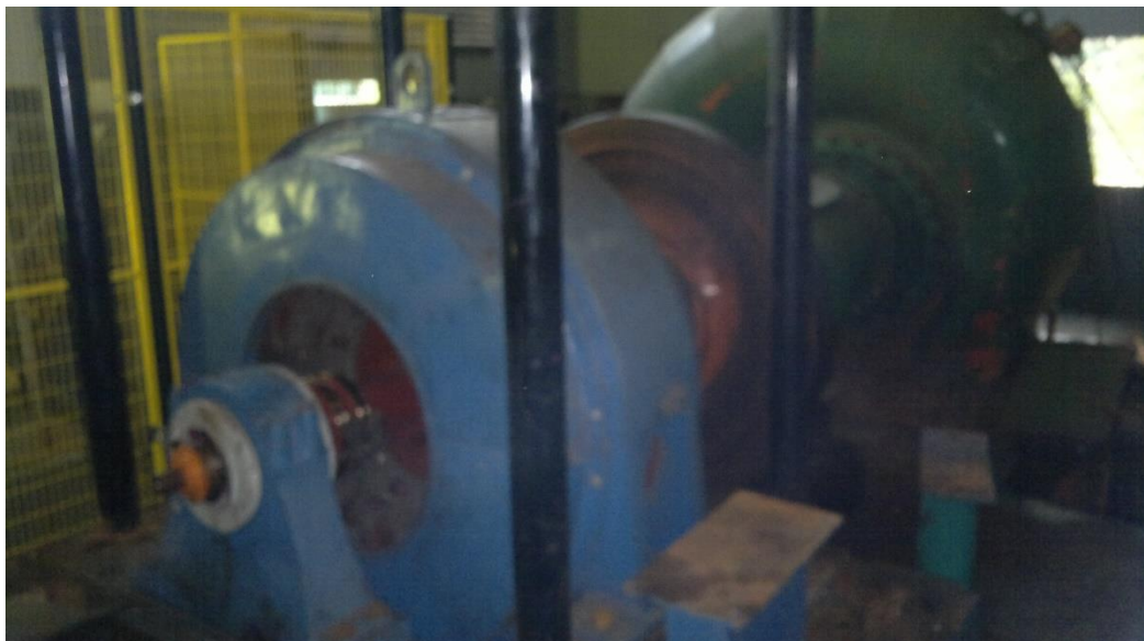
Figura 9 – Gerador Elétrico CGH Salto São Luiz. Fonte: Autoria Própria.
