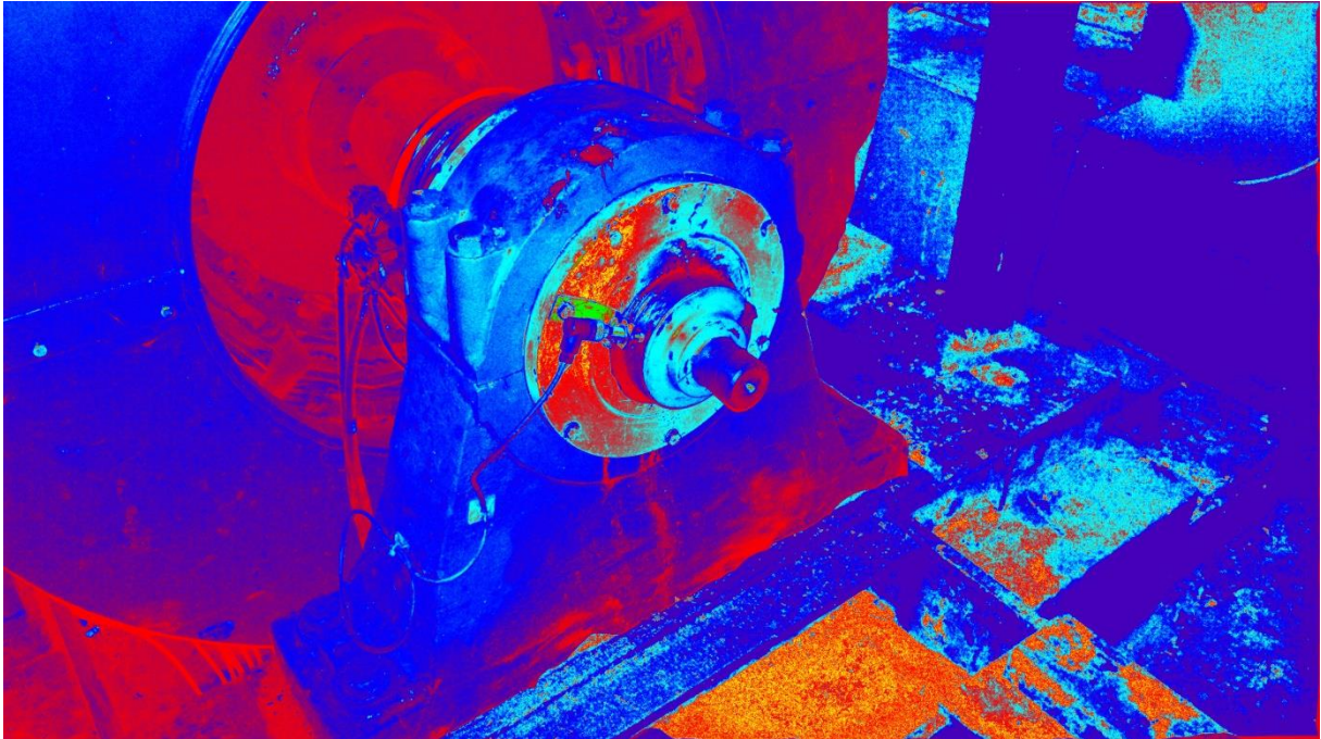
Figura 22 – Avaliação Termográfica do Gerador. Fonte: Autoria Própria.
