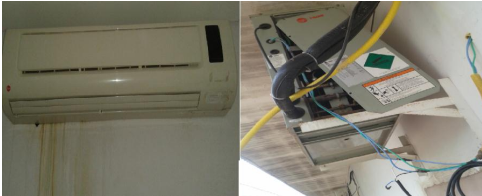
Figura 22 – Aparelhos de ar condicionado em má condição de uso. Fonte- Autoria própria.
