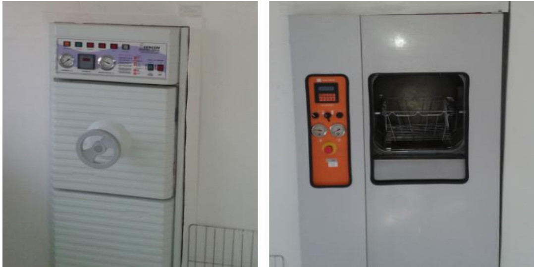
Figura 23 – Sistema de Esterilização – Autoclaves. Fonte- Levantamento de dados in loco.
