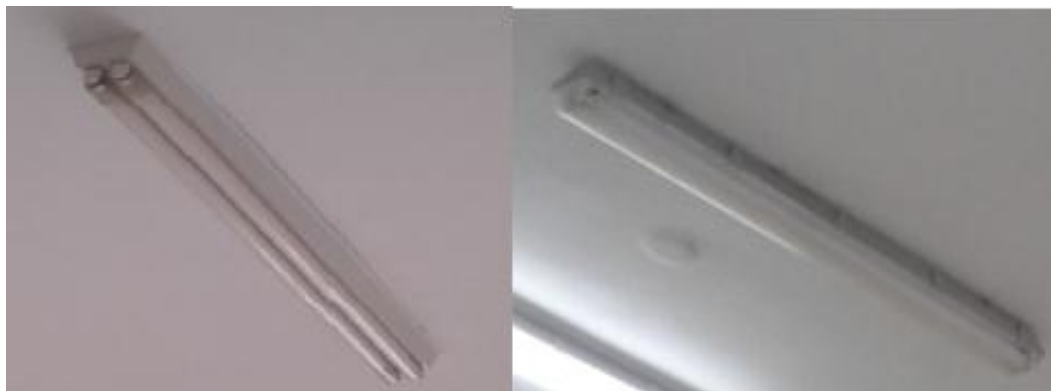
Figura 21 – Tipos de luminárias ineficientes existentes na instalação em estudo. Fonte- Autoria própria.
