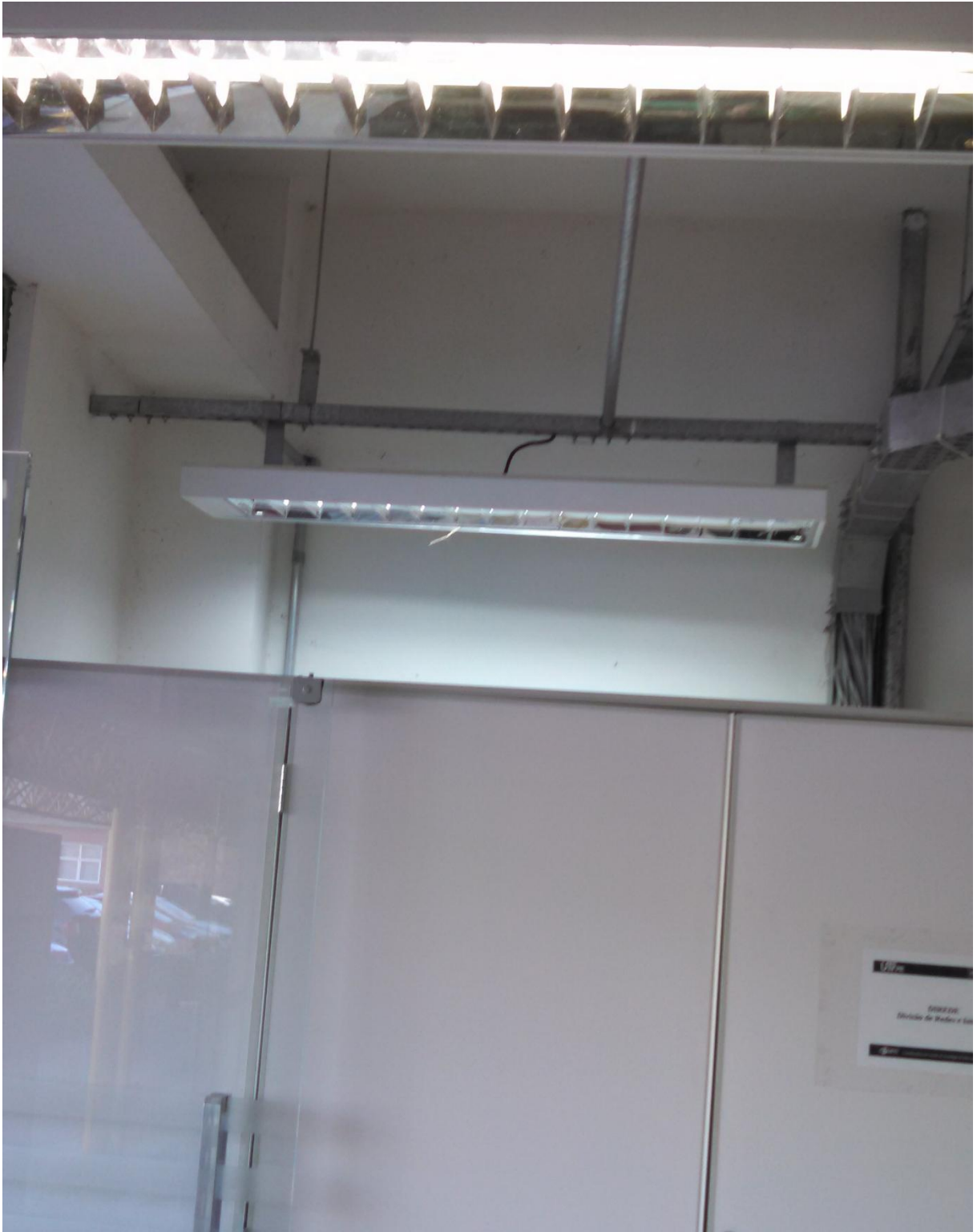
Figura 12 - Sala de redes, J1, as 08:40, 05 de abril de 2018. Fonte: Autoria propria.
