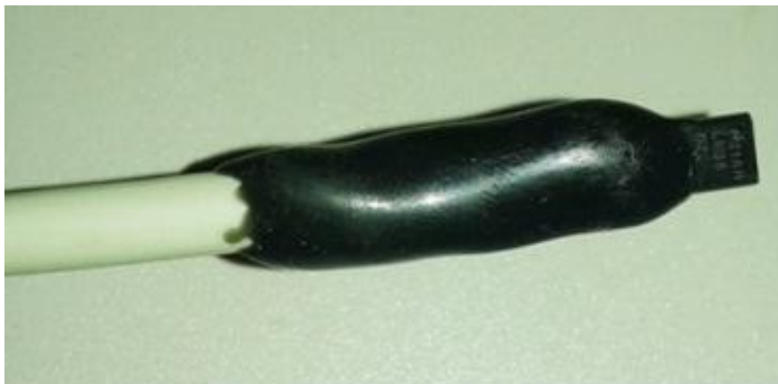
Figura 22 - Montagem da isolação dos terminais do sensor com o cabo. Fonte: Autoria própria.
