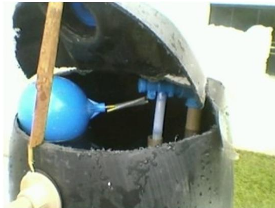
Figura 33 - Sistema de controle de nível dos reservatórios.
