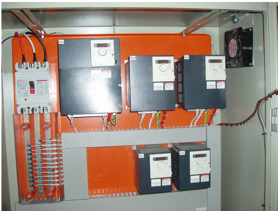
Figura 20: Painel de controle com os inversores. Fonte: Autoria própria.
