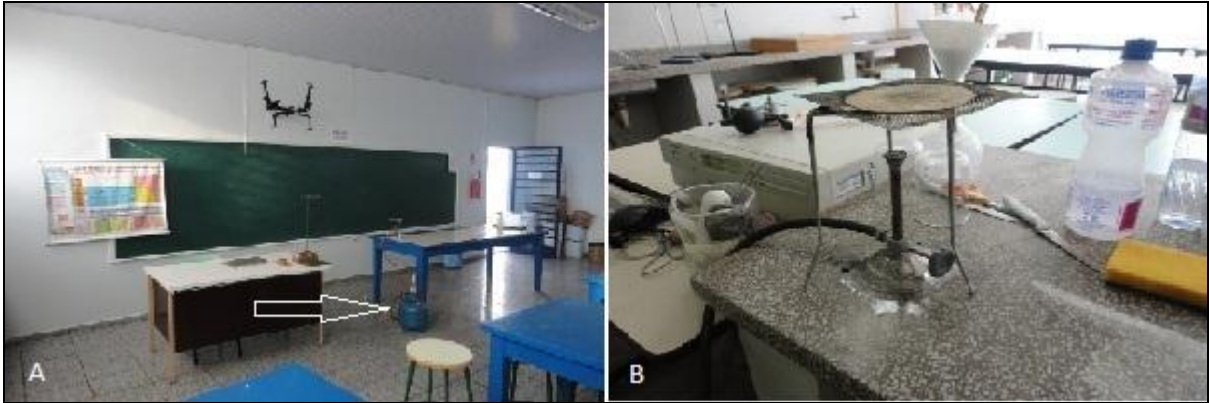
Figura 8 – Presença de botijões de gás dentro das salas
