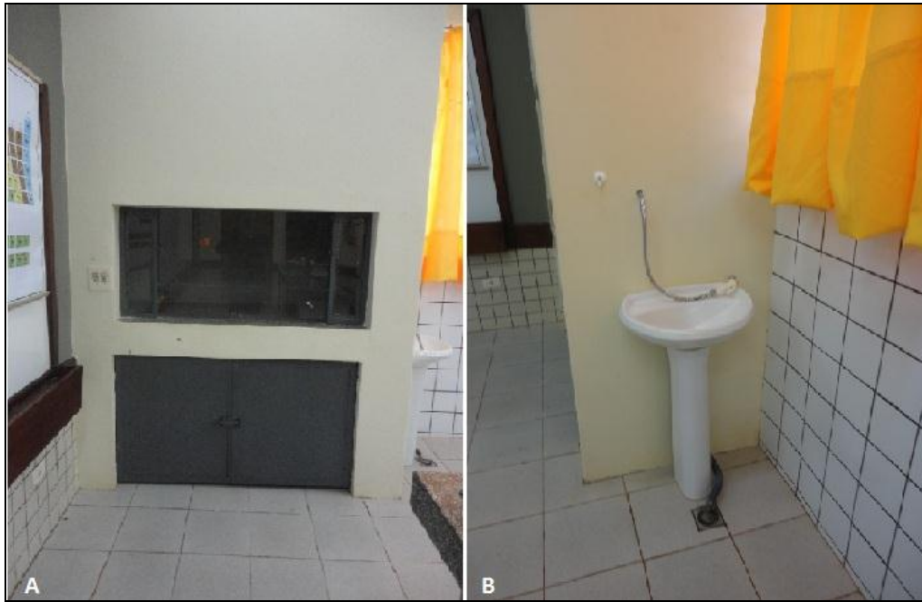
Figura 13 – Capela de exaustão e lava-olhos
