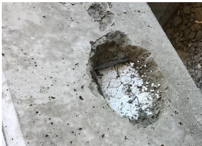
Figura 41 - Pilar rompido na região do isopor.
