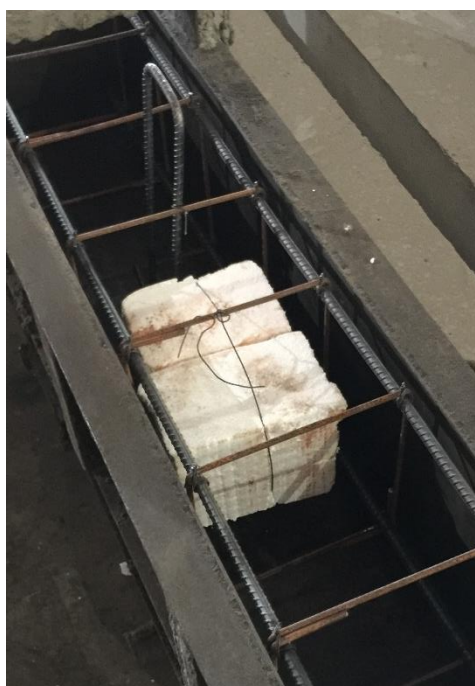
Figura 40 - Isopor presente no interior do pilar.
