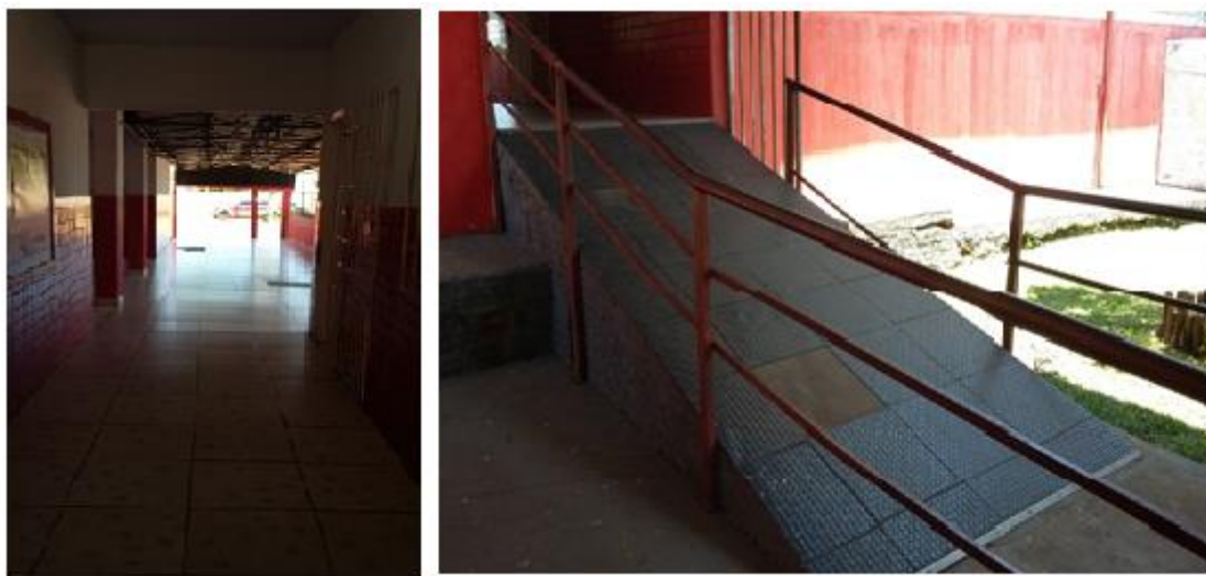
Figura 32 - Corredor e Rampa da Escola Municipal Zélia Almeida Maciel Fonte: Autoria Própria (2016)
