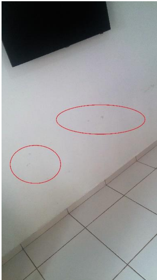
Figura 52 - Bolhas na Alvenaria
