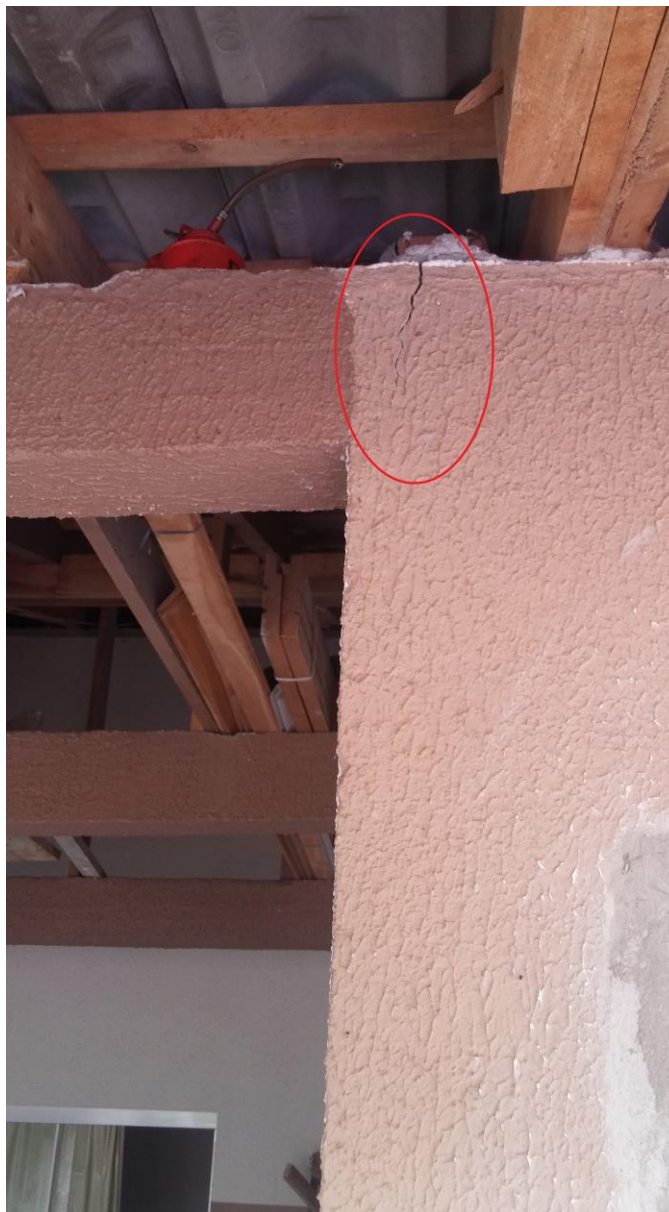
Figura 32 - Rachadura pergolado externo Fonte: Autor (2017)
