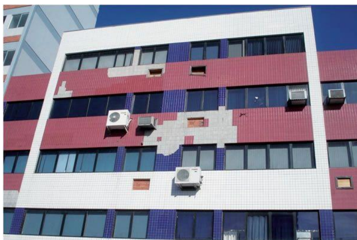
Figura 18 - Descolamento de Revestimento cerâmico em fachada Fonte: PINI (2014).
