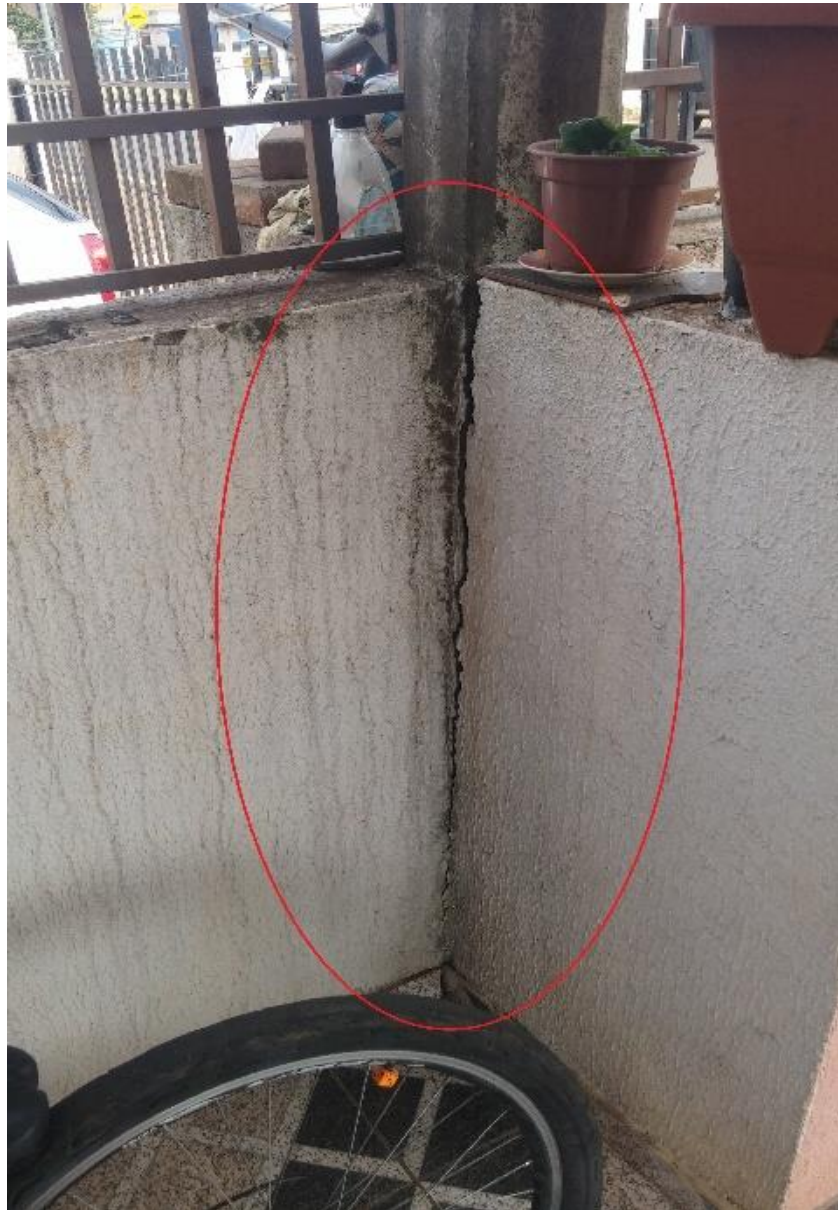
Figura 42 - Rachadura muro externo Fonte: Autor (2017)
