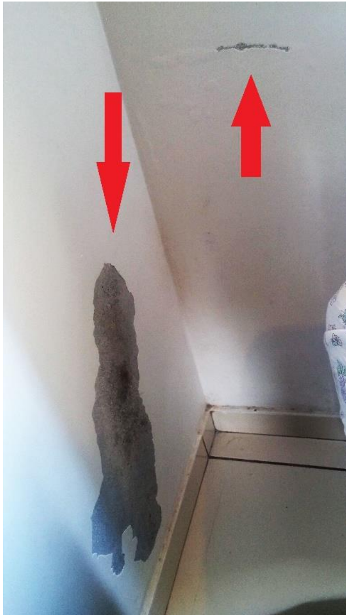
Figura 55 - Descolamento de revestimento e bolhas Fonte: Autor (2017)
