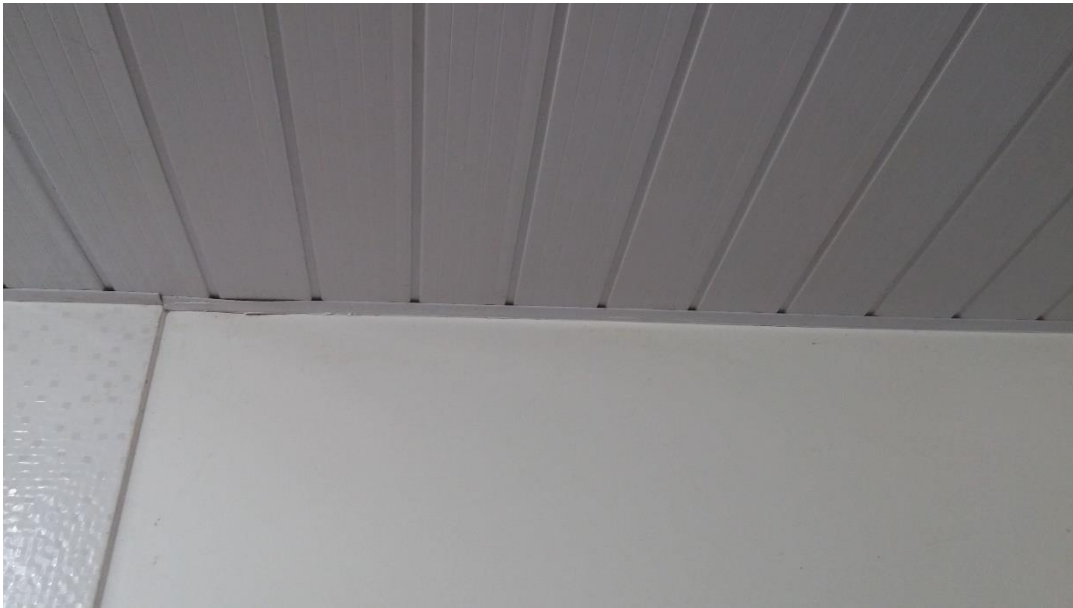
Figura 38 - Abaulamento do forro
