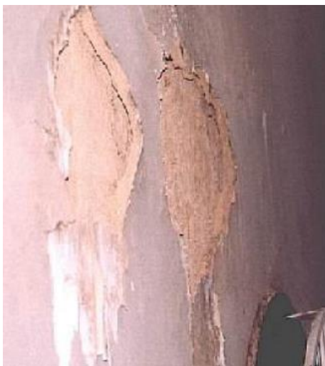
Figura 16 - Descolamento de revestimento argamassado Fonte: OLIVEIRA (2016).
