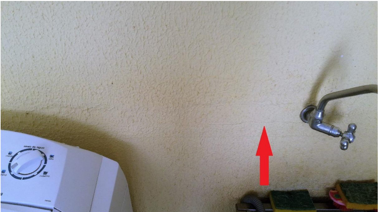
Figura 49 - Fissura em Alvenaria
