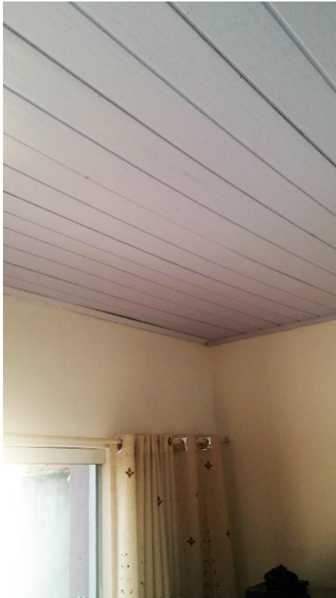
Figura 56 - Empenamento do forro
