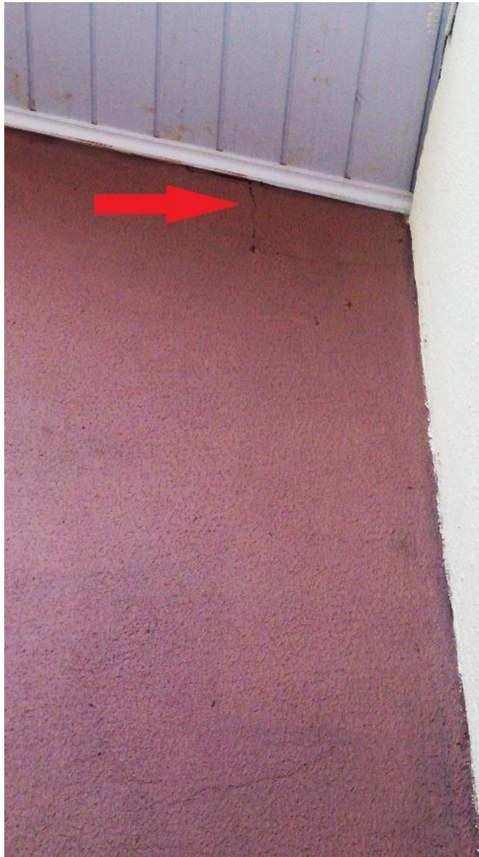
Figura 58 - Trinca em Alvenaria
