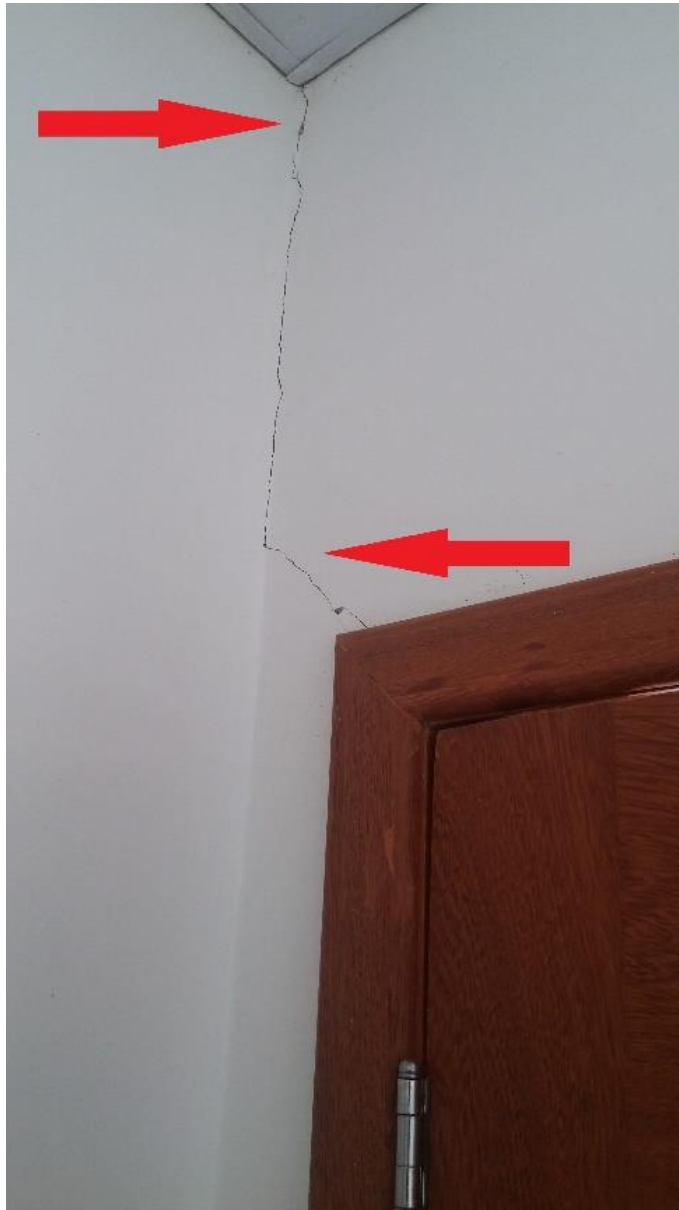
Figura 46 - Rachadura em Alvenaria Fonte: Autor (2017)
