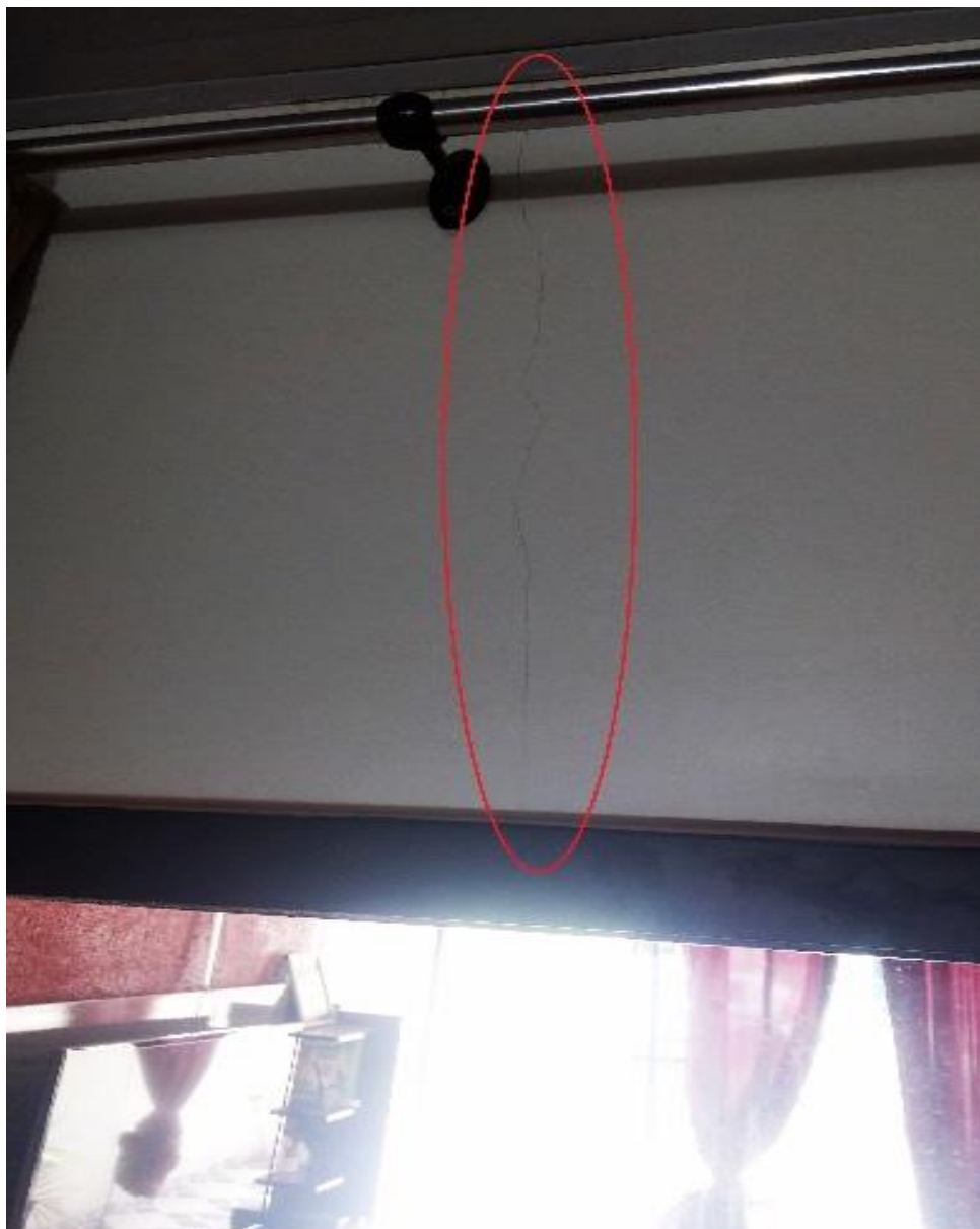
Figura 39 - Trinca em Alvenaria Fonte: Autor (2017)
