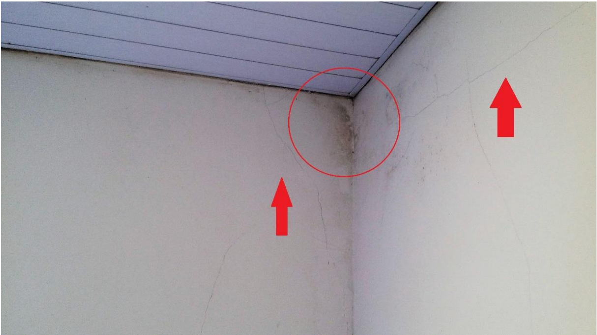
Figura 50 - Trincas e Mofo em Alvenaria
