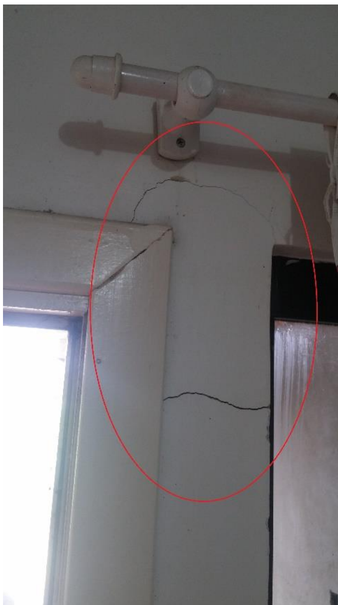
Figura 37 - Rachadura e Trinca em Alvenaria Fonte: Autor (2017)
