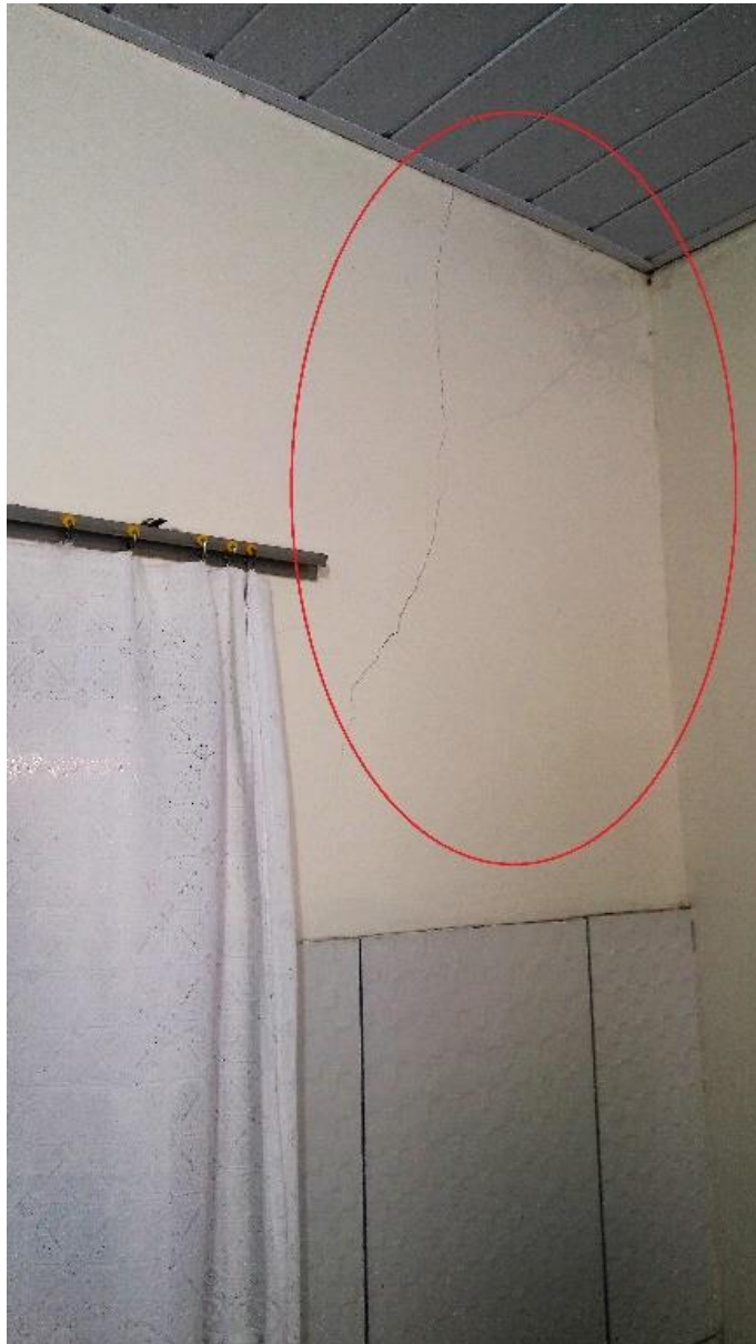
Figura 29 - Trincas e mofo Fonte: Autor (2017)
