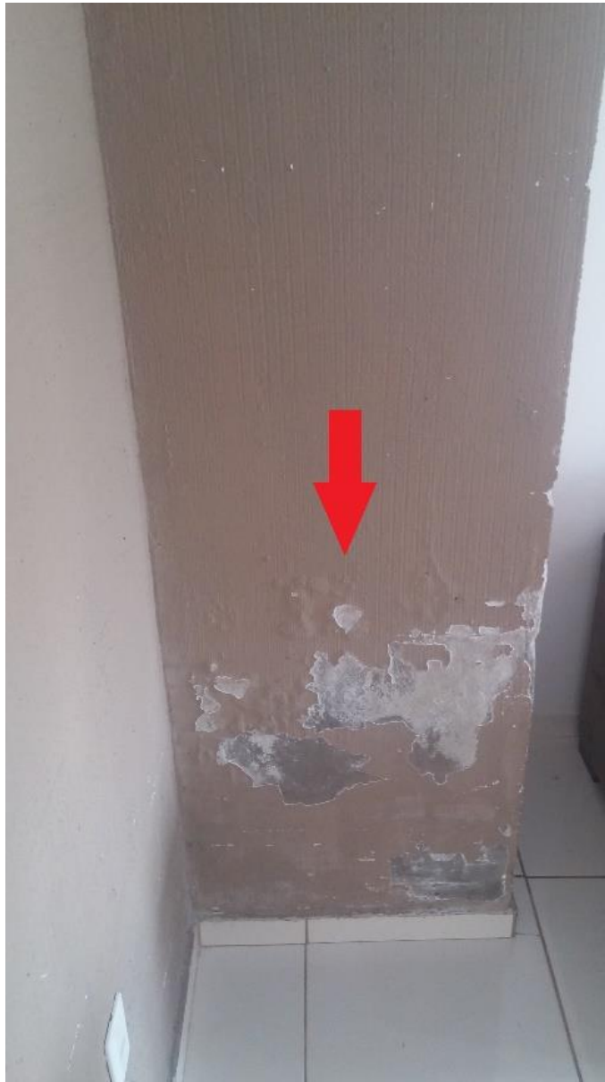
Figura 53 - Descolamento de revestimento Fonte: Autor (2017)
