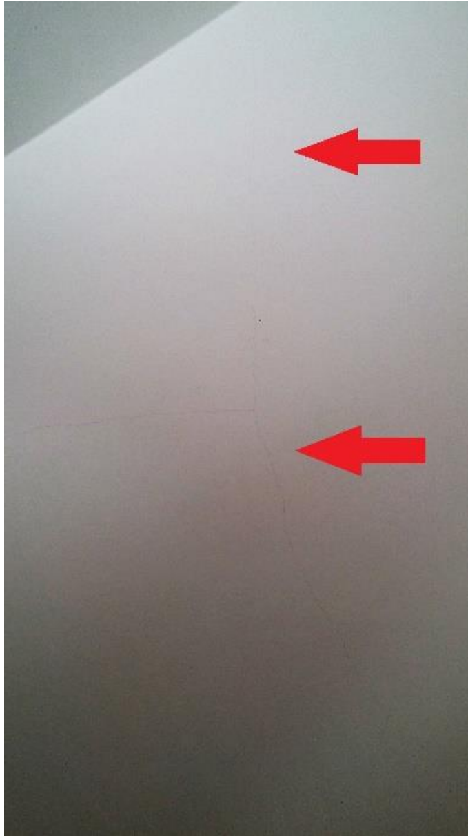
Figura 47 - Fissuras em Alvenaria
