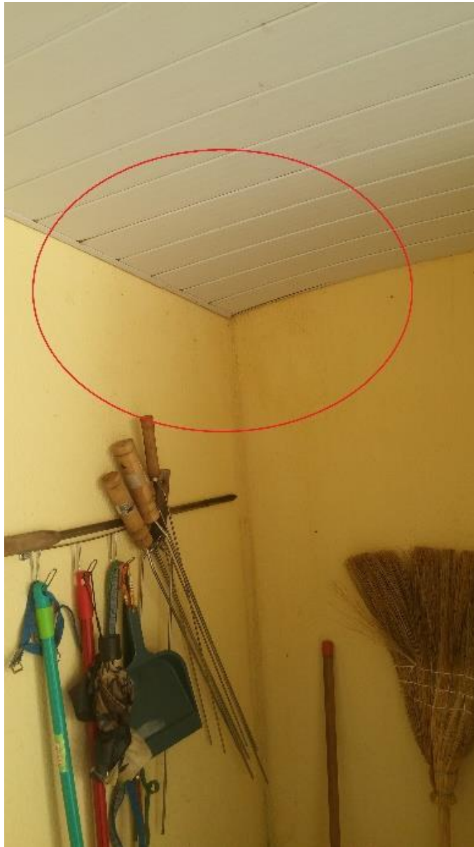
Figura 48 - Abaulamento de forro Fonte: Autor (2017)
