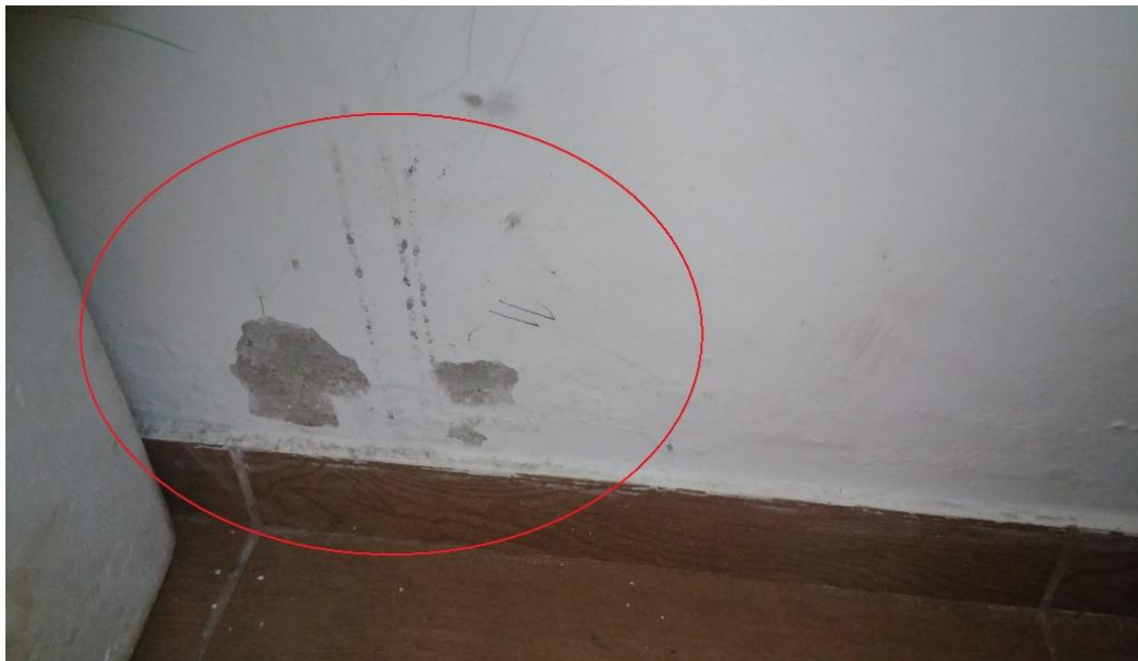
Figura 40 - Descolamento de revestimento Fonte: Autor (2017)
