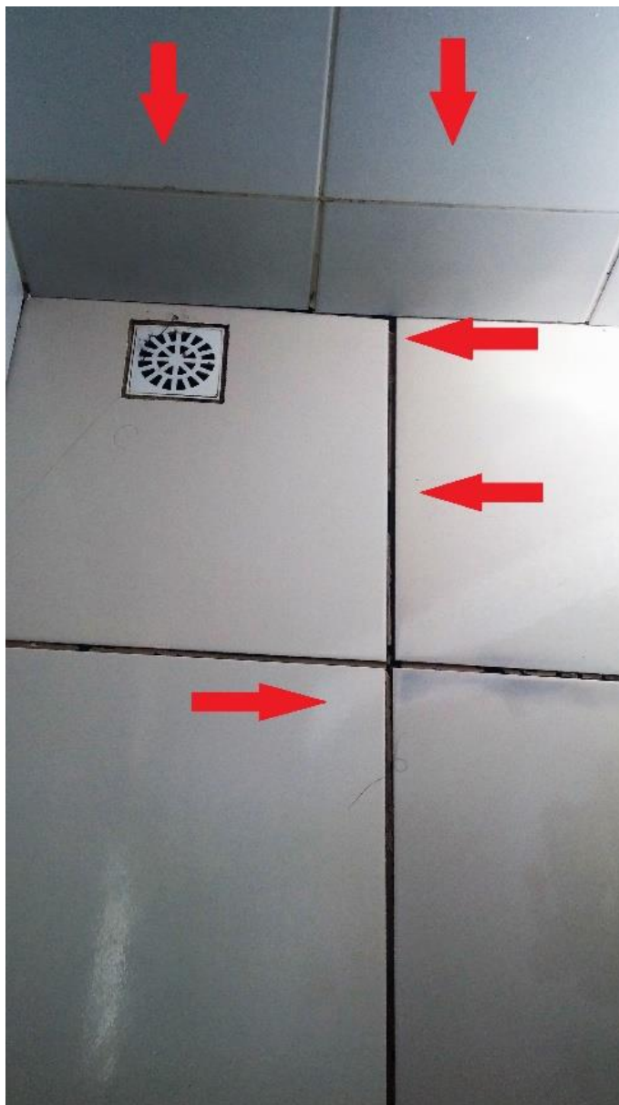
Figura 54 - Defeitos no rejunte e infiltração
