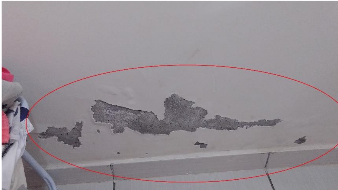
Figura 30 - Destacamento do revestimento Fonte: Autor (2017)
