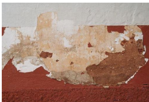
Figura 17 - Descolamento de revestimento argamassado Fonte: OLIVEIRA (2016).
