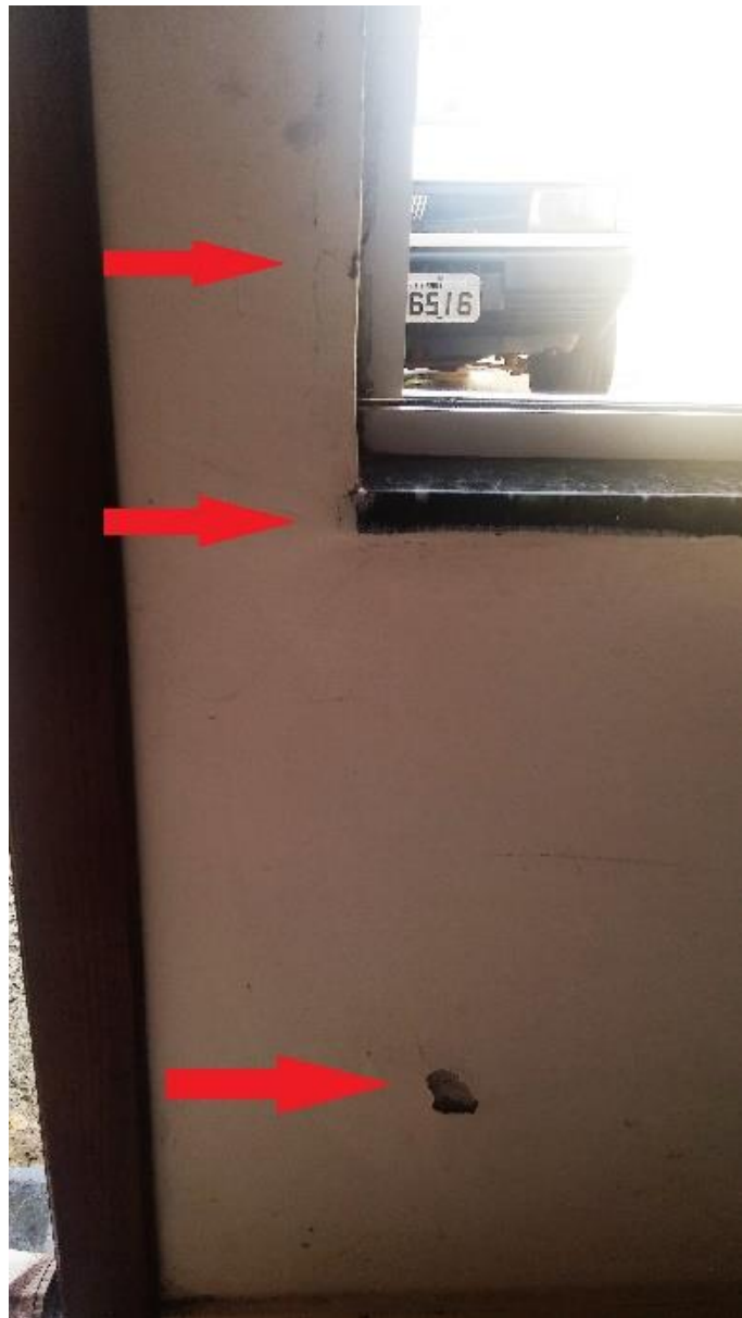
Figura 57 - Trincas e descolamento
