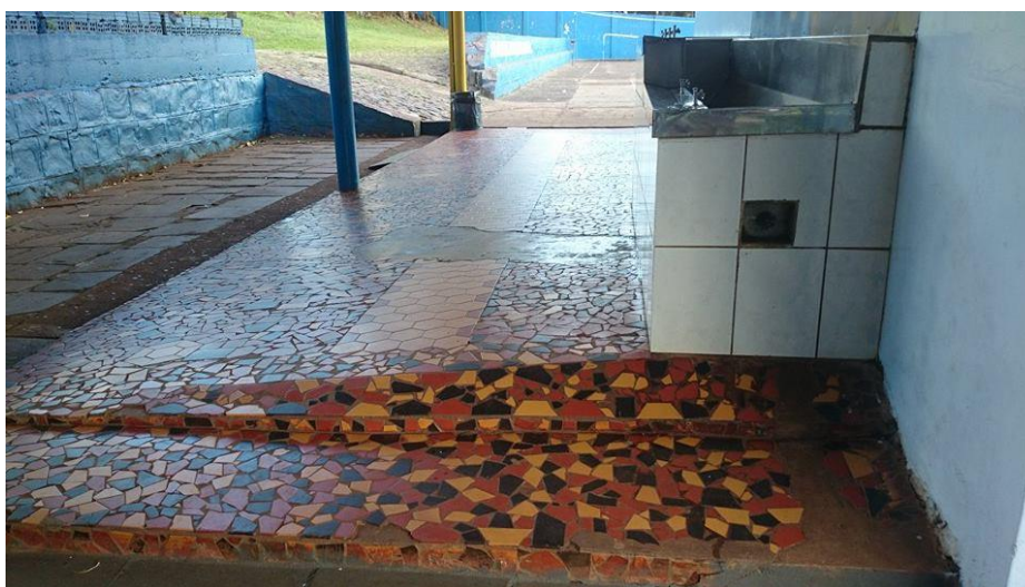
Fotografia 31 – Acesso precário ao bebedouro Fonte: a autora, 2015
