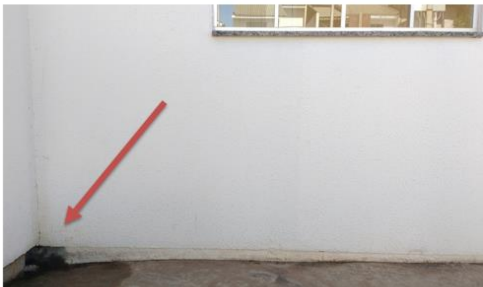
Figura 25 - Abertura para escoamento de água da chuva Fonte: Autoria própria (2017).
