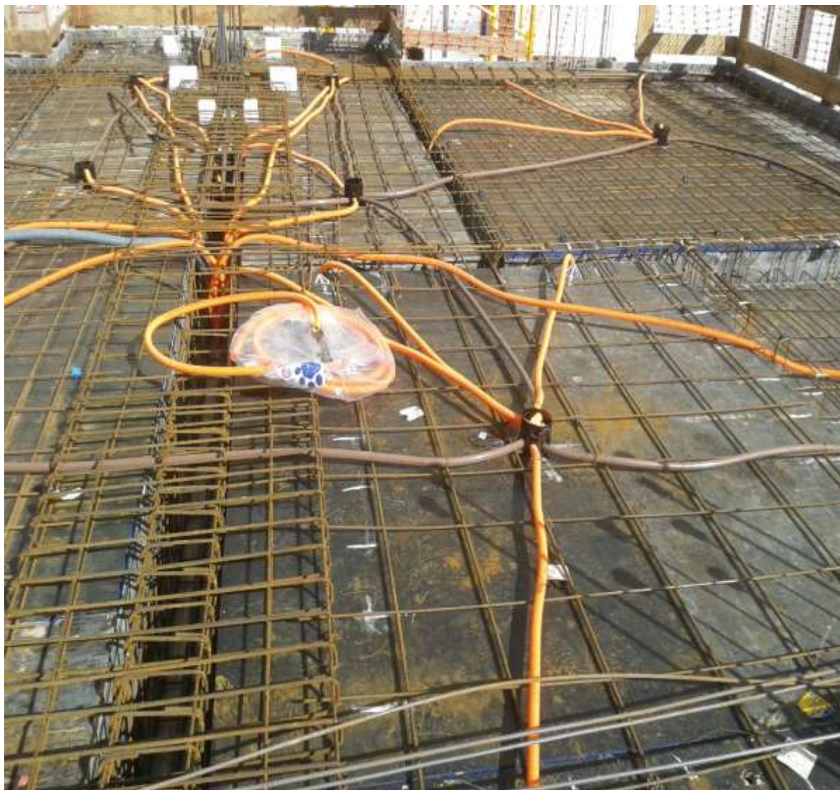
Figura 8: Eletrodutos e caixas de passagem na fôrma de LMS Fonte: Adquirida pelos autores.
