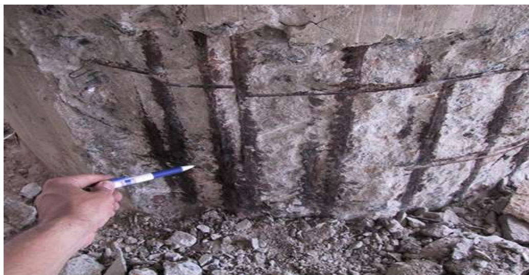
Figura 2: Pilar de concreto armado com armadura exposta Fonte: Dr. Marcelo H. F. Medeiros – UFPR, 2008.
