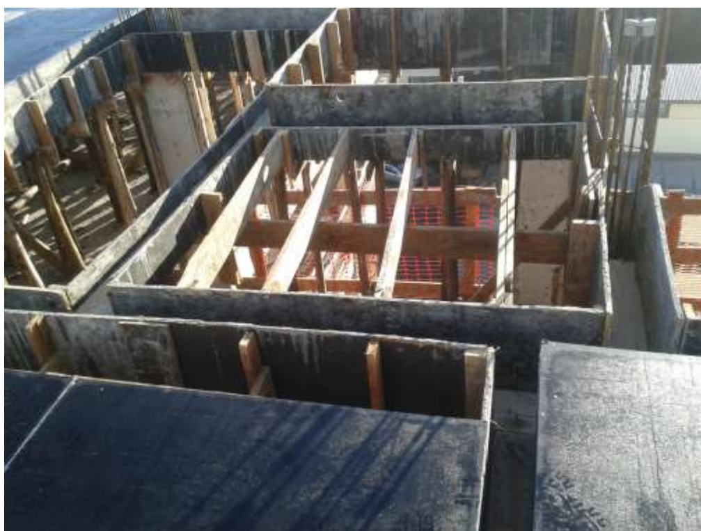
Figura 4: Fôrmas de LMS, com escoras longarinas e travessas aparentes Fonte: Adquirida pelos autores
