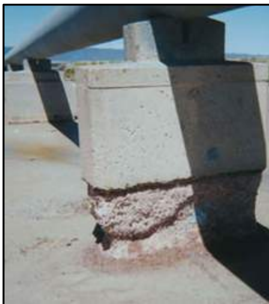
Figura 16 - Estrutura de concreto deteriorada por ataque de sulfatos. Fonte: Adaptado de SPEC-NET (2016).
