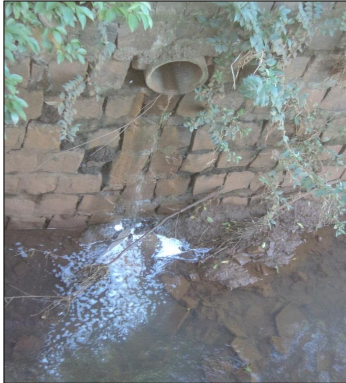
Figura 21 - Tubos de Esgoto II Fonte: A autora, 2014.
